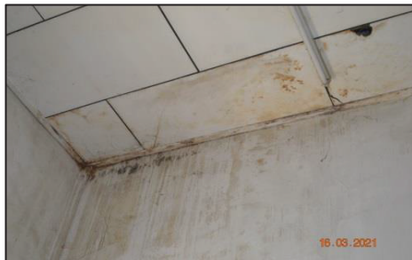
IKS Bukit Kor, Marang - Kesan Kebocoran Pada Struktur Saluran Atap (16.03.2021) (Sumber: Jabatan Audit Negara)
