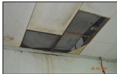
IKS Batu 5 Dungun - Siling Runtuh Disebabkan Kebocoran Pada Struktur Saluran Atap (23.03.2021) (Sumber: Jabatan Audit Negara)
