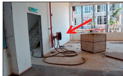
Bangunan JTC - Hose Reel/Dirosakkan (10.03.2021) (Sumber: Jabatan Audit Negara)
