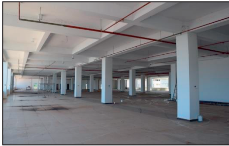
Bangunan JTC - Ruang Niaga Tingkat Bawah Terbengkalai (10.03.2021) (Sumber: Jabatan Audit Negara)
