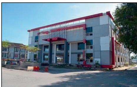
Bangunan JTC - Keadaan Luar Bangunan Terbengkalai (10.03.2021) (Sumber: Jabatan Audit Negara)
