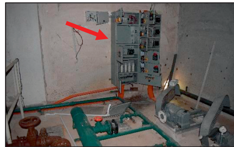
Bangunan JTC - Peralatan Elektrikal STP yang Hilang (10.03.2021) (Sumber: Jabatan Audit Negara)
