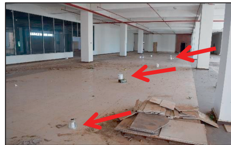
Bangunan JTC - Kecurian Pendawaian Elektrik dan Lampu (10.03.2021) (Sumber: Jabatan Audit Negara)
