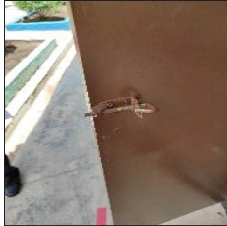
Bilik Darjah, SJK(T) Ladang Kampung Baru - Tombol Pintu Tidak Dipasang (05.03.2021) (Sumber: Jabatan Audit Negara)
