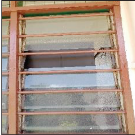
Bilik Darjah, SJK(T) Ladang Kampung Baru - Cermin Tidak Diganti (05.03.2021) (Sumber: Jabatan Audit Negara)
