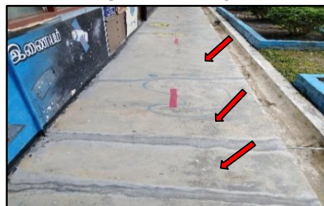
Laluan Kaki Lima, SJK(T) Ladang Kampung Baru - Kerja Membaiki Lantai yang Tidak Sempurna (05.03.2021) (Sumber: Jabatan Audit Negara)
