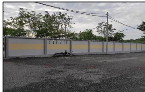
Pagar Sekolah, SJK(T) Ladang Semenyih - Tembok yang Telah Dicat (08.04.2021) (Sumber: Jabatan Audit Negara)
