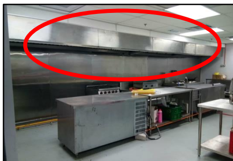
Ruang Dapur Makanan Axiata Arena - Pengubahsuaian Pada Ruang Dapur Tanpa Kelulusan (14.09.2020)
