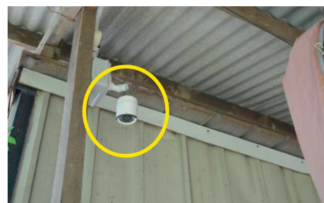
PTS Padang Kambing - Kamera CCTV di luar Pejabat PTS (19.11.2021) (Sumber: Jabatan Audit Negara)
