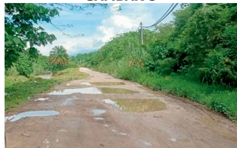
PTS Kalumpang - Jalan masuk ke lokasi PTS Kalumpang berlokap air (24.11.2021) (Sumber: Jabatan Audit Negara)
