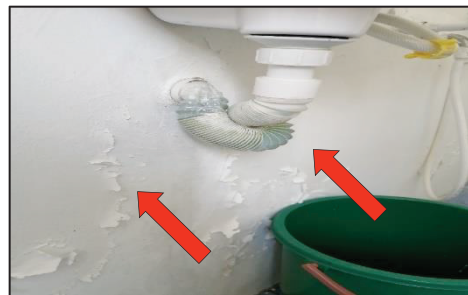
Tandas Guru, SJK(T) Ladang Kampung Baru - Saluran bawah Singki Dinding Tidak Kemas dan Cat Dinding Menggelupas (05.03.2021) (Sumber: Jabatan Audit Negara)
