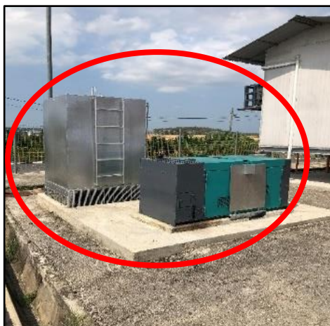
Tapak GIRN Kong Kong, Masai -Tangki Diesel 1500 Ltr & Generator (17.02.2020) (Sumber: Jabatan Audit Negara)
