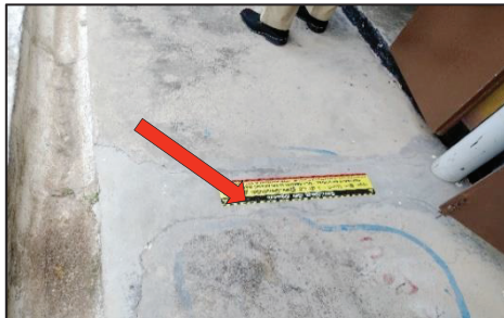
Laluan Kaki Lima, SJK(T) Ladang Kampung Baru - Lantai Retak (05.03.2021) (Sumber: Jabatan Audit Negara)
