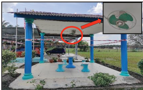
Pondok Bacaan, SJK(T) Ladang Kampung Baru - Kipas Tidak Diganti Baharu (05.03.2021) (Sumber: Jabatan Audit Negara)
