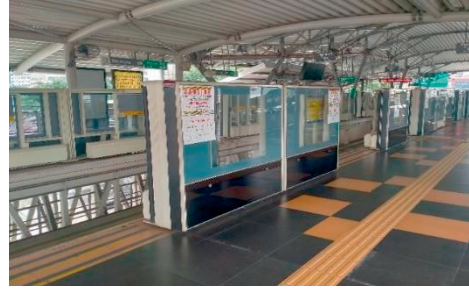
Stesen Titiwangsa – KL Monorail - Screen door disediakan tetapi tidak berfungsi (22.10.2021) (Sumber: Jabatan Audit Negara)
