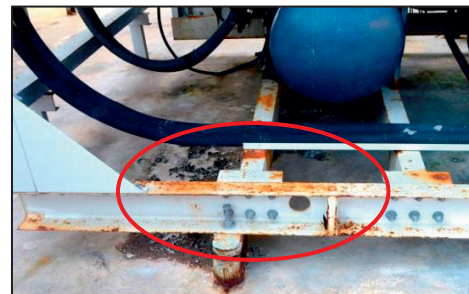
PB Sentral - Tapak Chiller yang Berkarat (17.02.2021) (Sumber: Jabatan Audit Negara)
