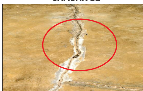
PB Sentral - Rekahan dan Retakan Permukaan Bumbung (17.02.2021) (Sumber: Jabatan Audit Negara)
