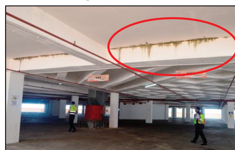
PB Plaza - Resapan Air Pada Beam (17.02.2021) (Sumber: Jabatan Audit Negara)
