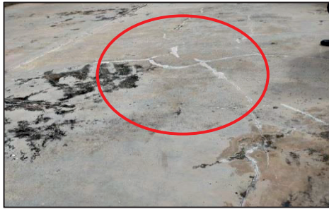
PB Square - Rekahan dan Retakan Permukaan Bumbung (17.02.2021) (Sumber: Jabatan Audit Negara)
