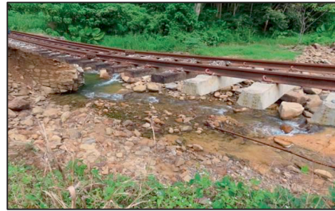
KM114/8, Landasan Keretapi Laluan Halogilat ke Tenom - Kejadian Wash Out /Tanah Runtuh (28.09.2021) (Sumber: Jabatan Keretapi Negeri Sabah)
