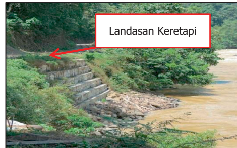
KM124/2, Landasan Keretapi Laluan Halogilat ke Tenom - Kawasan Berisiko Berlakunya Tanah Runtuh/Hakisan Tebing (18.03.2021) (Sumber: Jabatan Audit Negeri Sabah)
