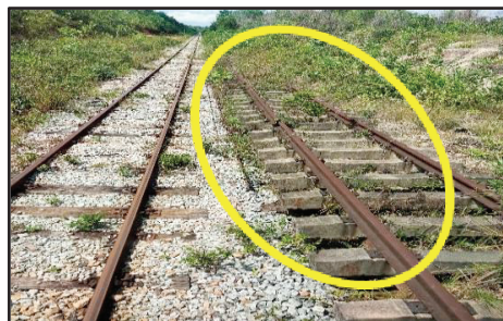
Jajaran Pasir Gudang - Rel-Rel Lama Masih Berada di Sepanjang Jajaran Walaupun Rel Baru Telah Dipasang (09.09.2020) (Sumber: Jabatan Audit Negara)
