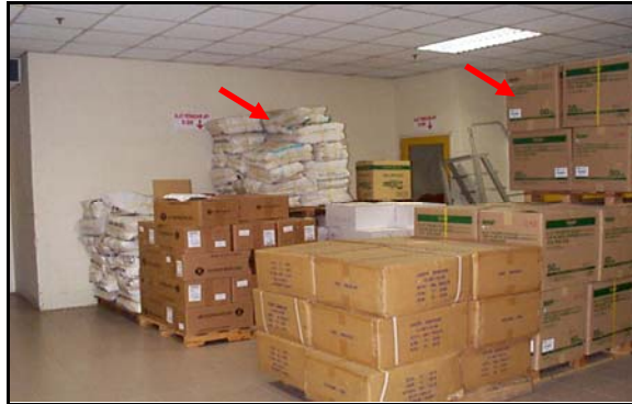
Susunan Stok Menghalang Fire Extinguisher Dan Hose Reel Di Stor Pusat
