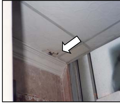
Siling Yang Bocor
