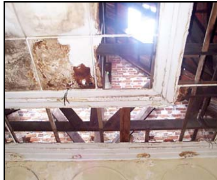
Keadaan Struktur Dan Bumbung Yang Sudah Rosak
