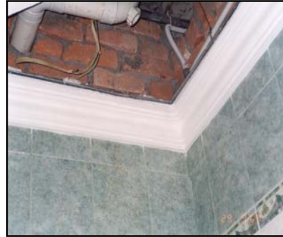
Paip Yang Tidak Ditutupi Siling
