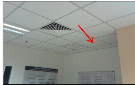
Bilik IT101 - Kesan Resapan Air Di Siling Telah Diselesaikan Pada 04.12.2014 Selepas Teguran Audit (Sumber: Jabatan Kerja Raya)
