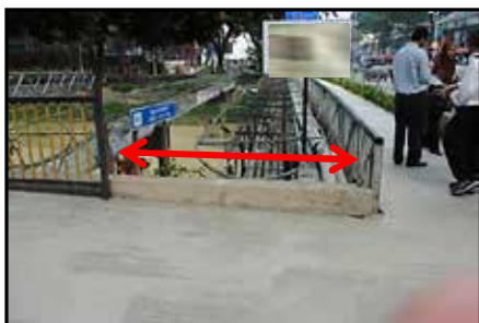
Laluan Pejalan Kaki Melintasi Sungai Gombak - Pagar Keselamatan Tidak Dipasang Sepenuhnya (09.10.14)
