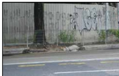
Jalan Chow Kit - Jalan Pahang - Kerb Yang Telah Pecah (21.10.2014)
