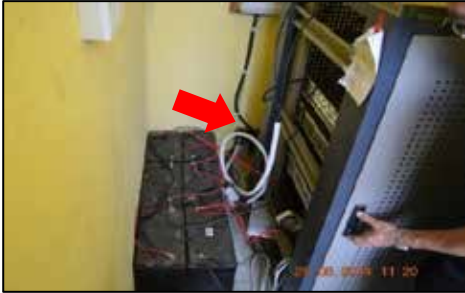
Stesen Kekal Aktif GNSS Pulau Mataking, Sabah - Sisi Mountable Rack Yang Tidak Dapat Ditutup (25.06.2014)
