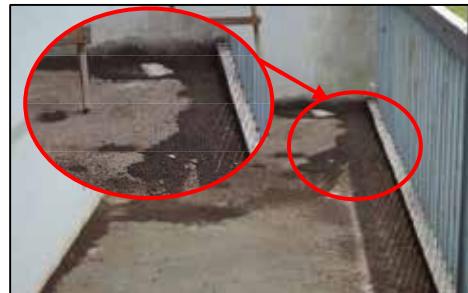
Unit G005 Blok G, Kuarters DCA Langkawi - Najis Kelawar Dibiarkan Dan Tidak Dibersihkan (23.07.2014)
