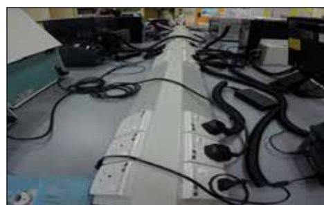
Makmal Patologi - Wayar Peralatan ICT Di Workstation Telah Dikemaskan (05.01.2015)
