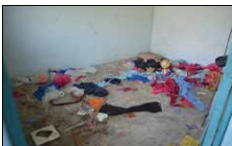
Unit 3918 Blok E, Kwarters DCA Johor Bahru - Kwarters Dipenuhi Barangan Terbuang (09.12.2014)
