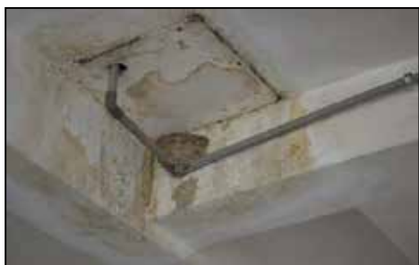
Blok Mawar, Kwarters DCA Sibul - Kesan Kebocoran Air Di Parkir (27.08.2014)
