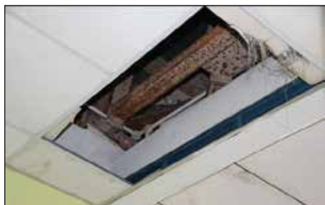
IPG Raja Melewar, Seremban, Negeri Sembilan - Siling Yang Telah Pecah Di Bangunan Astaka (13.11.2014)
