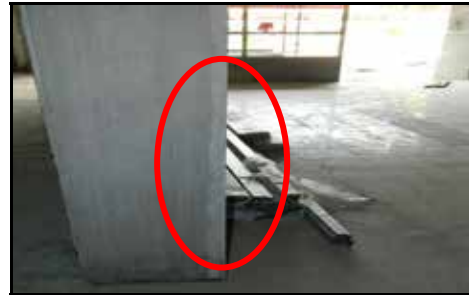
KMSN Pulau Pinang - Pembinaan Struktur Tiang ACOTEC Tidak Lurus (11.09.2014)
