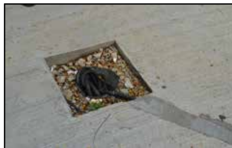
Di Laluan Pejalan Kaki, Jalan Ipoh - Penutup Kabel Elektrik Yang Hilang (09.10.2014)
