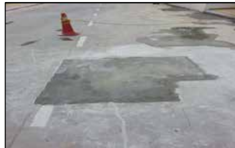
Kawasan Auditorium - Kerja-Kerja Pembaikan Jalan Konkrit Retak Telah Dilakukan Pada 29.10.2014 Selepas Teguran Audit (Sumber: Jabatan Kerja Raya)
