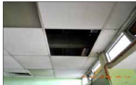
Kompleks Bukit Mertajam - Siling Pecah (10.09.2014)
