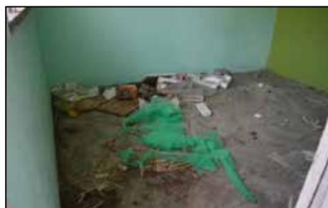
Unit 3904, Kwarters DCA Johor Bahru - Keadaan Kwarters Yang Ditinggalkan Dipenuhi Sampah Sarap (09.12.2014)
