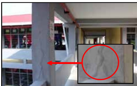
SMK Putatan - Kesan Keretakan Yang Telah Dibaiki Jelas Kelihatan Pada Column Tingkat 1, Di Blok Akademik A (24.06.2014)
