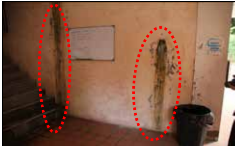
IPG Gaya, Kota Kinabalu, Sabah - Kebocoran/Resapan Air Asrama Lelaki (02.12.2014)
