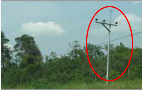
KM 13 Dan Kampung Bukit Kranji Jalan Outer Ring Ke Batu 15 Jalan Kuching - Serian - Kecurian Kabel Elektrik (07.11.2014)
