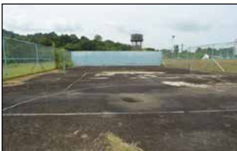
Kuarters DCA Langkawi - Lantai Gelanggang Tenis Rosak (23.07.2014)
