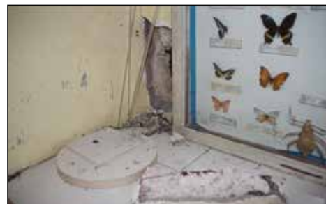
IPG Gaya, Kota Kinabalu, Sabah - Dinding Yang Telah Retak Di Makmal Sains (02.12.2014)
