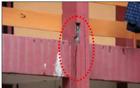
IPG Kota Bharu, Kota Bharu, Kelantan - Rekahan Di Tiang Bangunan Asrama Lelaki (15.12.2014)
