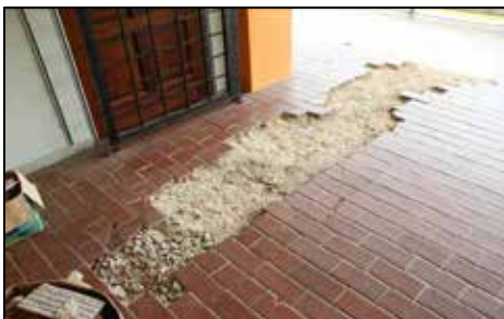
IPG Raja Melewar, Seremban, Negeri Sembilan - Jubin Pecah Di Tingkat 1 Bangunan Astaka (13.11.2014)
