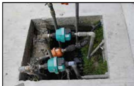
Di Laluan Pejalan Kaki Jalan Datuk Haji Eusoff - Keadaan Meter Air Yang Membahayakan Pejalan Kaki (09.10.2014)
