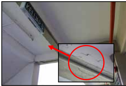
SMK Kinarut - Keretakan Berulang Pada Beam Yang Telah Dibaiki Di Asrama Puteri (24.06.2014)
