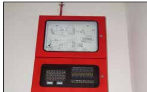
Bangunan COT Seni Kreatif, PIS, Pasir Gudang, Johor - Fire Alarm Panel Telah Dilengkapi Dengan Lukisan Pelan Bangunan (Mimic Diagram) (23.02.2015) (Sumber : KPM)
