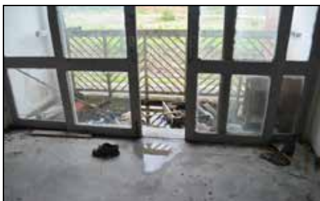
Unit G2 Blok Cempaka, Kwarters DCA Sibu - Keadaan Kwarters Yang Ditinggalkan (27.08.2014)
