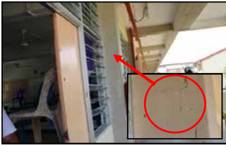
SMK Kinarut - Rekahan Simen Pada Column Di Blok Akademik (24.06.2014)
