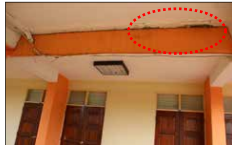
IPG Raja Melewar, Seremban, Negeri Sembilan - Kesan Resapan Air Di Siling Koridor Perpustakaan (13.11.2014)
