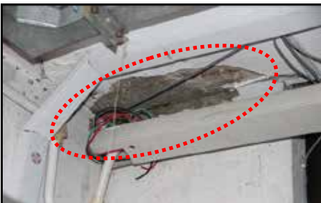
IPG Gaya, Kota Kinabalu, Sabah - Siling Yang Mempunyai Kesan Retak Di Bangunan Pentadbiran Aras 1 (02.12.2014)
