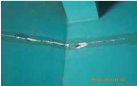
Tingkat 19 Menara UMNO - Keretakan Dinding (10.09.2014)
