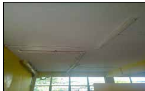
SMK Putatan - Kerja Waterproofing Dilakukan Semula Serta Mengecat Semula Kesan Resapan Air (29.12.2014)
