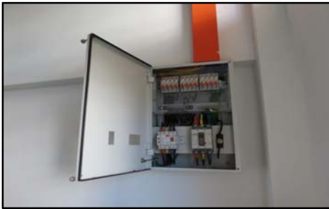
Bangunan COT Mekanikal, PUO, Ipoh, Perak - Lukisan Litar Skematik Tidak Dilekatkan Di Bahagian Dalam Pintu Papan Agihan (11.08.2014)
