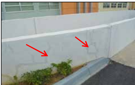
Laluan Parking Bangunan Pesakit Luar - Parapet Wall Retak (29.10.2014)
