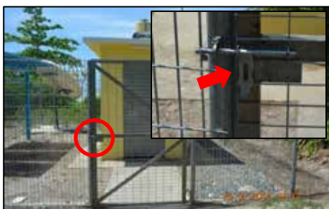
Pulau Mataking, Sabah - Kunci Pintu Pagar Utama Stesen Tidak Dipasang (25.06.2014)
