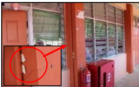
SMK Datuk Panglima Abdullah - Keretakan Pada Permukaan Dinding Dan Beam Di Bilik Dobi, Asrama Puteri (22.06.2014)
