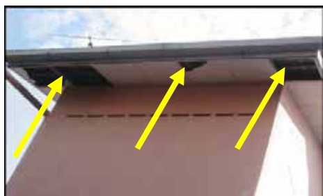
Hotel Seri Malaysia Ipoh - Siling Yang Telah Tertanggal Di Menara Hotel (02.12.2014)
