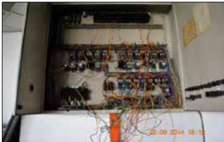
Kompleks Bukit Mertajam - Pendawaian Switchboard Tidak Teratur (10.09.2014)
