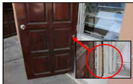
SMK Bandaraya - Pintu Kayu Solid Tetapi Menggunakan Frame Aluminium Menyebabkan Mudah Rosak (25.06.2014)
