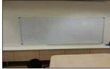
Bilik Mesyuarat RT131 - Built-In Whiteboard Telah Dipasang Pada 15.12.2014 Selepas Teguran Audit (Sumber: Jabatan Kerja Raya)
