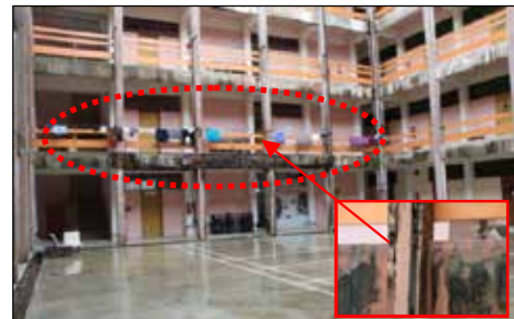
PG Kota Bharu, Kota Bharu, Kelantan - Rekahan Di Tiang Bangunan Asrama Perempuan (15.12.2014)
