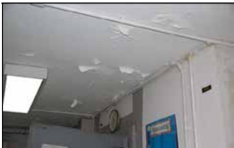
IPG Gaya, Kota Kinabalu, Sabah - Kesan Resapan Air Di Siling Unit Peperiksaan (02.12.2014)
