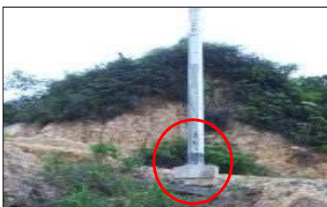
Rumah Wak Dan Rumah Dok, Miri - Tanah Terhakis Pada Dasar Tiang Elektrik (01.10.2014)
