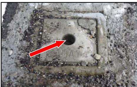
Kotak Pembedian, Bangunan COT Seni Kreatif, PIS, Pasir Gudang, Johor - Penutup Earth Chamber Bagi Sistem Perlindungan Kilat Pecah Dan Retak (25.08.2014)
