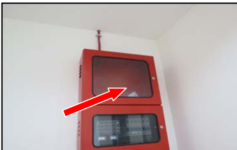
Bangunan COT Seni Kreatif, PIS, Pasir Gudang, Johor - Fire Alarm Panel Masih Tidak Dilengkapi Dengan Lukisan Pelan Bangunan (Mimic Diagram) (25.08.2014)
