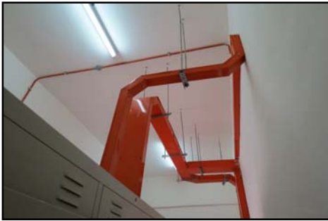
Bilik MSB, Bangunan COT Seni Kreatif, PIS, Pasir Gudang, Johor - Bilik Suis Utama Tidak Dilengkapi Dengan Sistem Pengesan Kebakaran (25.08.2014)
