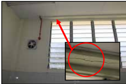
SMK Bandaraya - Keretakan Pada Beam Di Tandas Dewan Serbaguna (25.06.2014)
