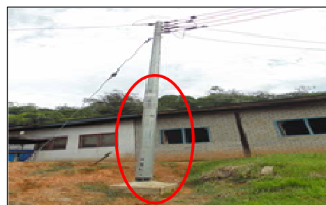
Rumah Sare, Repok Sarikei - Tiang Elektrik 9 Meter Condong (20.10.2014)
