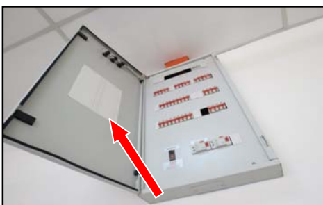
Pejabat Aras Satu, Bangunan COT Seni Kreatif, PIS, Pasir Gudang, Johor - Lukisan Litar Skematik Tidak Dilekatkan Di Bahagian Dalam Pintu Papan Agihan (25.08.2014)
