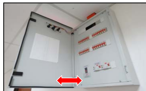
Pejabat Aras Satu, Bangunan COT Seni Kreatif, PIS, Pasir Gudang, Johor - Tiada Penyambungan Kabel Bumi Ke Pintu Papan Suis Bagi Tujuan Keselamatan (25.08.2014)
