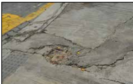
Di Laluan Pejalan Kaki, Jalan Ipoh - Laluan Pejalan Kaki Yang Rosak (09.10.2014)
