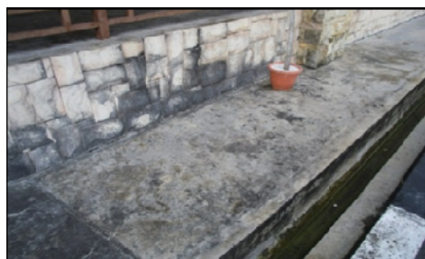
Hotel Seri Malaysia Kangar - Keadaan Lantai Yang Kotor Di Kawasan Luar Dewan Seri Anggerik 1, 2 & 3 (02.12.2014)
