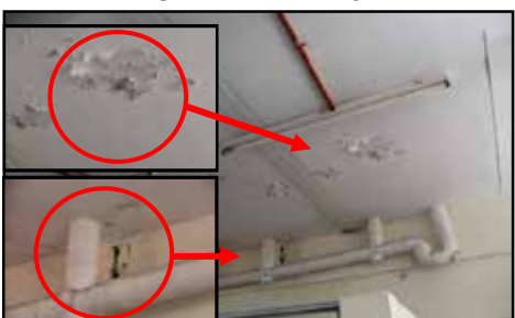
SMK Bandaraya - Permukaan Soffit Slab Mengelupas Disebabkan Oleh Resapan Air Di Tandas Asrama Putera (25.06.2014)
