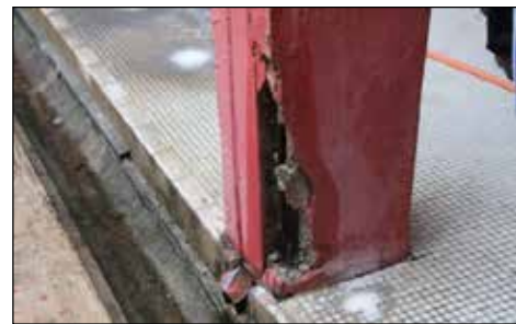
IPG Kota Bharu, Kota Bharu, Kelantan - Rekahan Di Tiang Bangunan Asrama Lelaki (15.12.2014)
