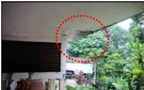
IPG Gaya, Kota Kinabalu, Sabah - Kebocoran/Resapan Air Di Laluan Pejalan Kaki Bangunan Pentadbiran (02.12.2014)
