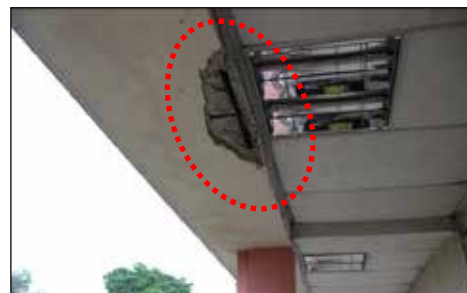
IPG Gaya, Kota Kinabalu, Sabah - Beam Yang Mempunyai Kesan Retak Di Koridor Bangunan Pentadbiran Aras 1 (02.12.2014)
