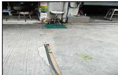
Di Bahagian Luar Kedai Makan Berdepan Dengan Jalan Ipoh - Pemasangan Sinki Dan Perpaipan Dipasang Secara Haram Melalui Laluan Pejalan Kaki (09.10.2014)
