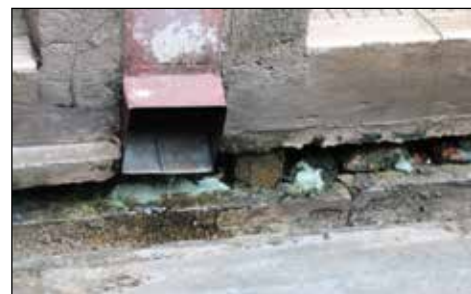
IPG Kota Bharu, Kota Bharu, Kelantan - Rekahan Longkang Bangunan Asrama Perempuan (15.12.2014)
