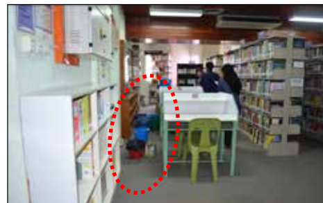
IPG Gaya, Kota Kinabalu, Sabah - Bekas Tadahan Air Terpaksa Disediakan Akibat Titisan Air Apabila Hujan Di Perpustakaan (02.12.2014)
