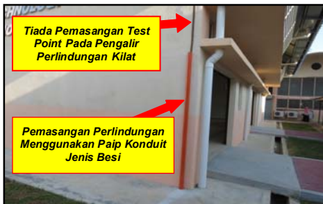
Bangunan COT Mekanikal, PUO, Ipoh, Perak - Tiada Pemasangan Test Point Pada Pengalir Perlindungan Kilat (25.08.2014)
