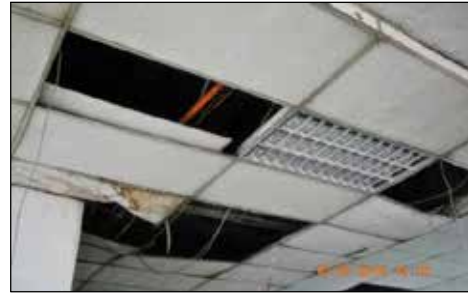
Tingkat 2 Kompleks Bagan - Siling Terkopak Dan Tidak Diperbaiki (10.09.2014)
