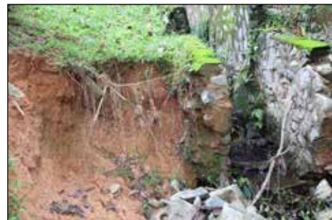
IPG Raja Melewar, Seremban, Negeri Sembilan - Tanah Runtuh Di Cerun Bukit Di Pintu Masuk Kedua IPG (13.11.2014)
