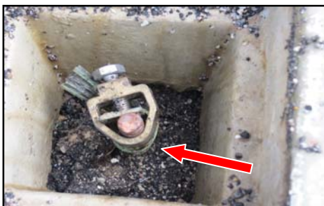
Kotak Pembedian, Bangunan COT Seni Kreatif, PIS, Pasir Gudang, Johor - Penyambungan Pada Earth Electrode Tidak Menggunakan Kaedah Cad Weld Seperti Yang Dinyatakan Dalam Dokumen Kontrak (25.08.2014)
