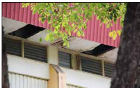
IPG Raja Melewar, Seremban, Negeri Sembilan - Siling Yang Telah Pecah Di Dewan Badminton (13.11.2014)
