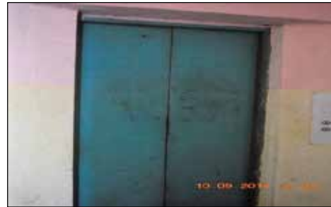
Tingkat 1 Kompleks Bagan - Lif Tidak Berfungsi (10.09.2014)
