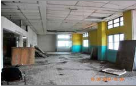
Tingkat 2 Kompleks Bagan - Aras 2 Terbiar Dan Tidak Disenggara (10.09.2014)
