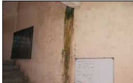
IPG Gaya, Kota Kinabalu, Sabah - Kebocoran/Resapan Air Asrama Lelaki (02.12.2014)
