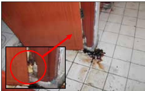
SMK Putatan - Frame Pintu Tandas Di Asrama Puteri Telah Reput Dan Belum Dibaiki (24.06.2014)
