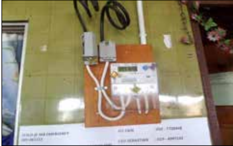
Rumah Dok, Miri - Meter Telah Dipasang (01.10.2014)
