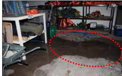
IPG Raja Melewar, Seremban, Negeri Sembilan - Takungan Air Akibat Kebocoran Di Stor Sukan Bangunan Astaka (13.11.2014)
