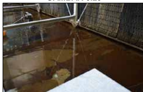
Aras 10 - Cooling Tower Yang Berlumut Dan Berkeladak (27.10.2014)
