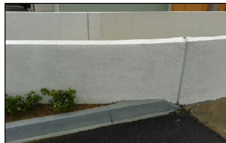
Laluan Parking Bangunan Pesakit Luar - Kerja-Kerja Pembaikan Parapet Wall Telah Dilakukan Pada 02.12.2014 Selepas Teguran Audit (Sumber: Jabatan Kerja Raya)
