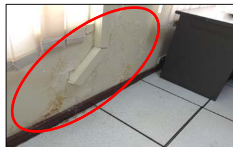
Kesan Resapan Air Pada Dinding Di Bilik Server HQE (28.10.2014)
