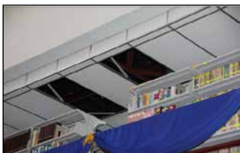
IPG Raja Melewar, Seremban, Negeri Sembilan - Siling Yang Pecah Di Perpustakaan (13.11.2014)
