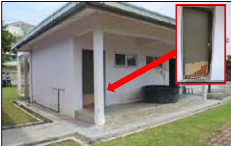
PPPn Selangor - Pintu Bilik Air Telah Rosak (Gambar Kecil) Tidak Diperbaiki (22.10.2014)
