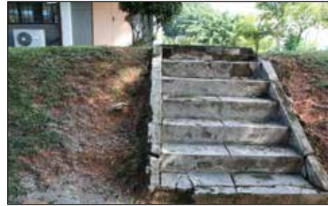
IPG Raja Melewar, Seremban, Negeri Sembilan - Tangga Di Bangunan Pentadbiran Telah Retak (13.11.2014)
