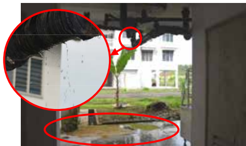
Blok Mawar, Kwarters DCA Sibul - Saluran Air Bocor Menyebabkan Air Bertakung (27.08.2014)
