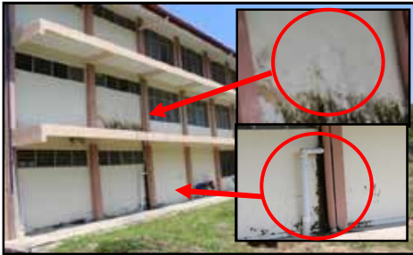
SMK Bandaraya - Kesan Resapan Air Di Belakang Blok Asrama Putera (25.06.2014)
