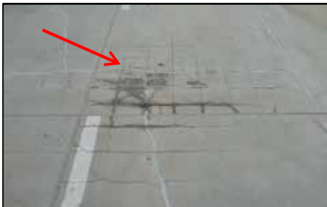
Kawasan Auditorium - Jalan Konkrit Retak (29.10.2014)
