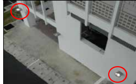
KMS Negeri Sembilan - Kedudukan Suis Lampu Spotlight Tidak Dapat Dikesan Menyebabkan Penggunaan Lampu 24 Jam Tanpa Henti (14.08.2014)
