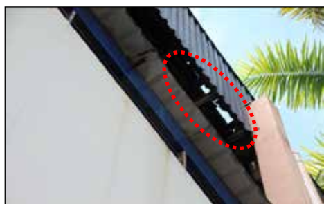
IPG Raja Melewar, Seremban, Negeri Sembilan - Siling Yang Telah Pecah Di Dewan Serbaguna (13.11.2014)
