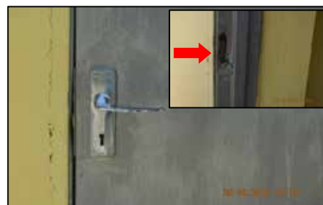
Pulau Mataking, Sabah - Alur Kunci Pintu Stesen Yang Telah Rosak (25.06.2014)
