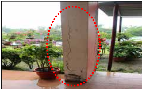
IPG Gaya, Kota Kinabalu, Sabah - Tiang Yang Telah Retak Di Lluhan Pejalan Kaki (02.12.2014)
