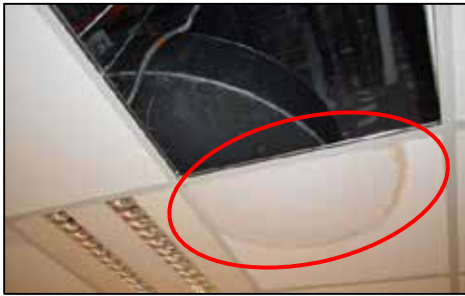
Bilik IT101 - Kesan Resapan Air Di Siling Menyebabkan Satu Lampu Tidak Menyala (27.10.2014)
