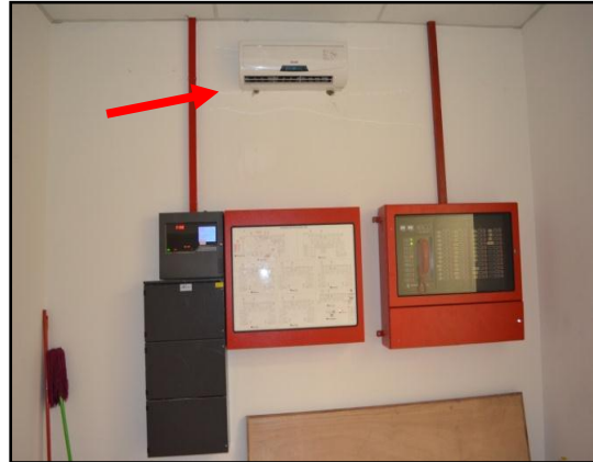
GAMBAR 15.2 Penyaman Udara Dipasang Di Atas Panel Elektrik
