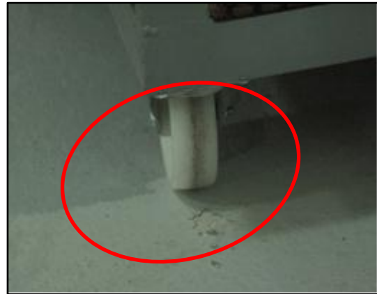
GAMBAR 12.19 Tayar Troli Yang Digunakan Menyebabkan Permukaan Lantai Rosak
