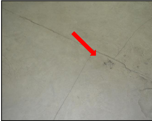
GAMBAR 4.13 Keretakan Pada Permukaan Lantai
