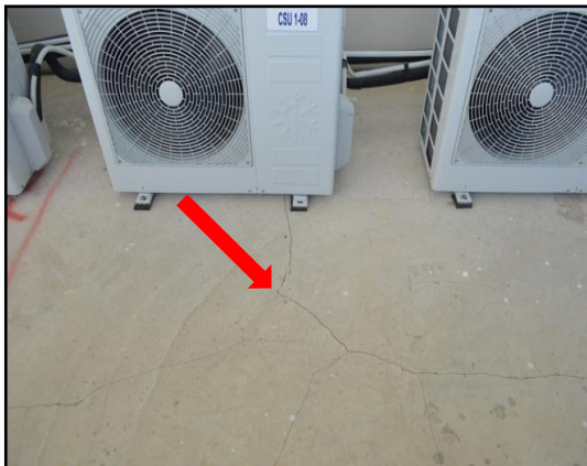
GAMBAR 4.15 Keretakan Pada Permukaan Lantai
