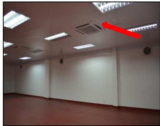
GAMBAR 4.19 Penyaman Udara Yang Belum Digunakan
