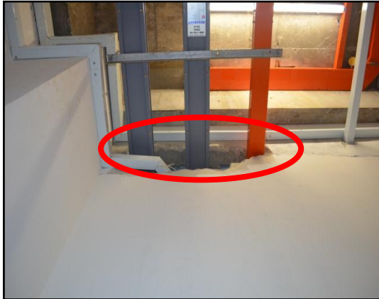
GAMBAR 15.5 Tiada Pemasangan Fire Barrier Di Laluan Trunking
