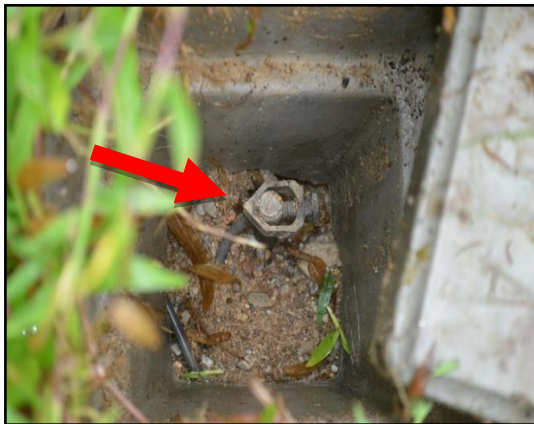
GAMBAR 15.3 Penyambungan Pada Earth Electrode Tidak Menggunakan Kaedah Exothermic Welding
