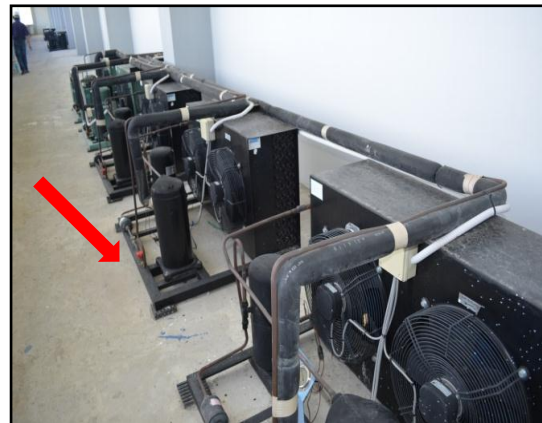
GAMBAR 4.16 Condensing Unit Diletakkan Di Atas Lantai
