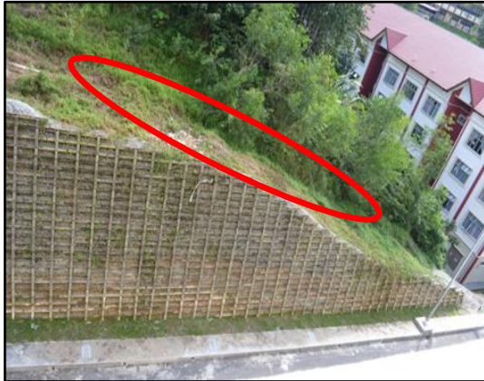
GAMBAR 15.1 Tiada Longkang Dibina Di Bahagian Atas Retaining Wall
