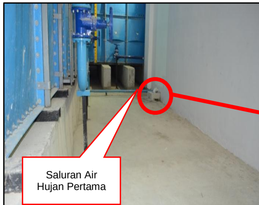
GAMBAR 15.14 Tiada Saluran Yang Dibina Dengan Sempurna Untuk Mengalirkan Air Hujan
