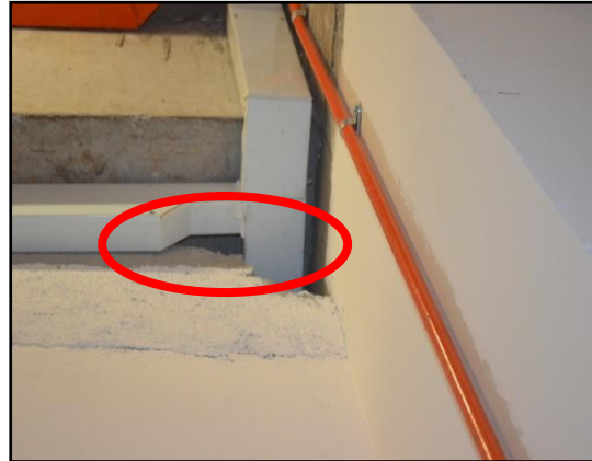
GAMBAR 15.6 Tiada Pemasangan Fire Barrier Di Laluan Trunking
