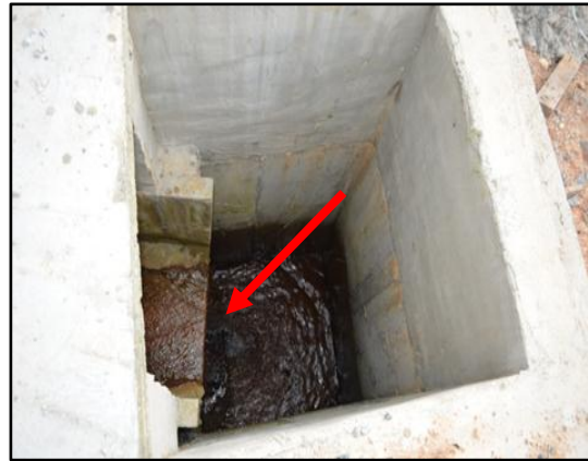
GAMBAR 15.21 Trash Screen Tidak Dipasang Di Bahagian Masuk Ke Retention Pond
