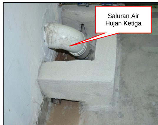
GAMBAR 15.16 Tiada Saluran Yang Dibina Dengan Sempurna Untuk Mengalirkan Air Hujan
