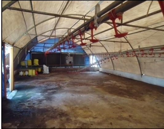
GAMBAR 16.13 Reban Ayam Tidak Digunakan Sejak Tahun 2009
