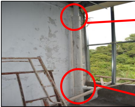
GAMBAR 15.18 Vent Pipe Dipasang Tidak Sama Saiz
