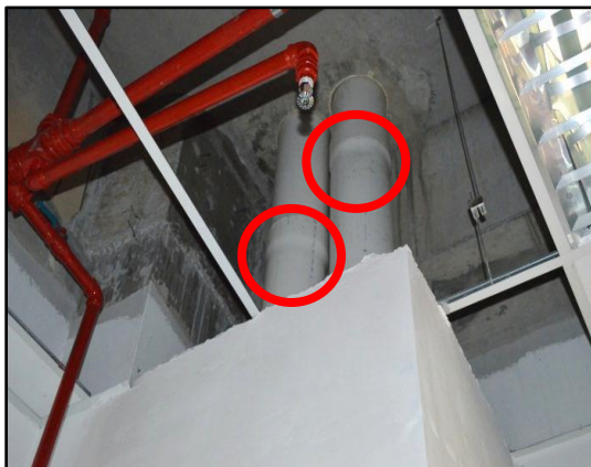
GAMBAR 15.19 Penyambungan Di Antara Saluran Air Hujan Tidak Dipasang Dengan Sleeve
