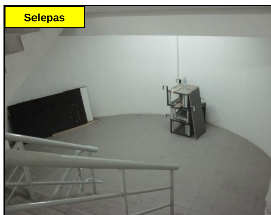
GAMBAR 12.8 Laluan Kecemasan Yang Telah Dibersihkan
