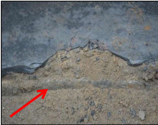
GAMBAR 15.20 Lantai Konkrit Tidak Dibina Dan Hanya Diletakkan Pasir Dan Lepaan Simen Di Atasnya
