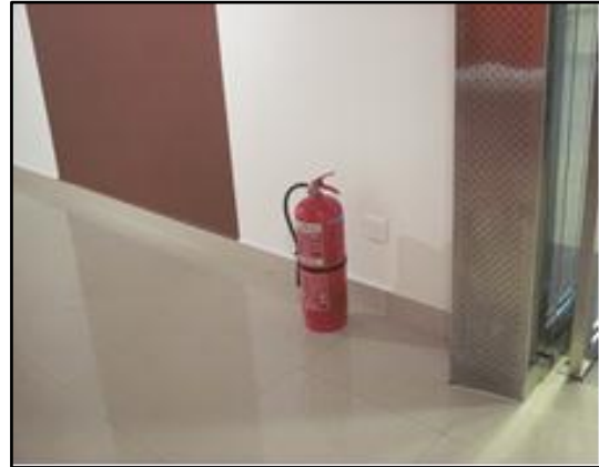
GAMBAR 12.5 Alat Pemadam Api Yang Masih Diletakkan Di Atas Lantai
