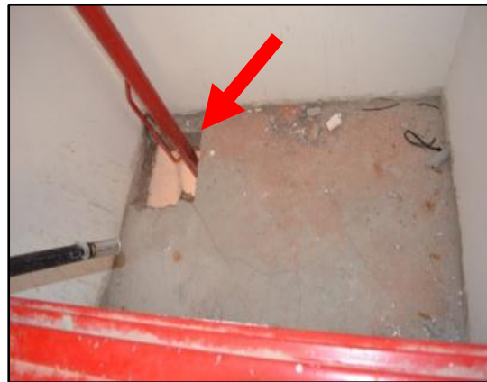
GAMBAR 15.4 Lubang Di Lantai Perlu Ditutup Dengan Fire Barrier
