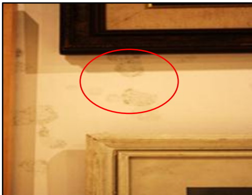
GAMBAR 12.21 Dinding Yang Ditumbuhi Kulat
