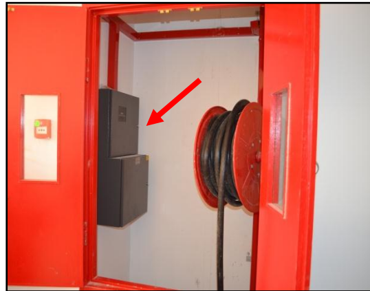
GAMBAR 15.9 Panel/DB Dipasang Di Dalam Ruang Hose Reel
