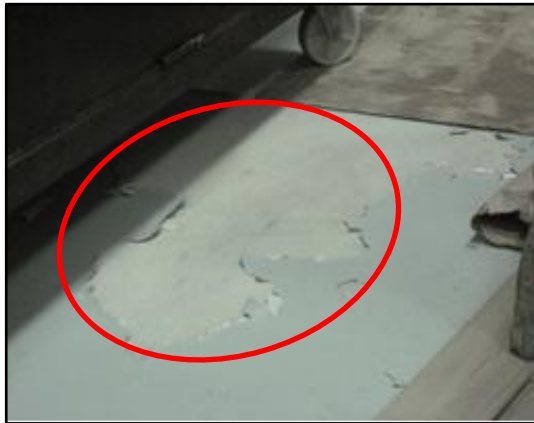
GAMBAR 12.18 Lantai Yang Rosak
