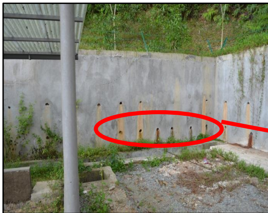
GAMBAR 15.22 Lantai Konkrit Tidak Dibina
