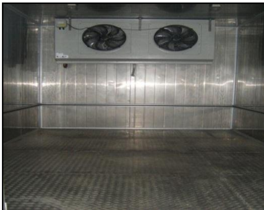
GAMBAR 4.20 Cold Room Yang Belum Digunakan
