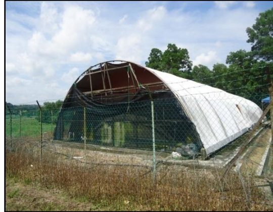
GAMBAR 16.14 Reban Ayam Tidak Digunakan Sejak Tahun 2009
