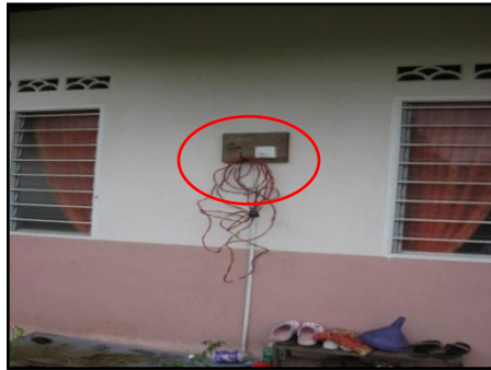
Rumah PBR Yang Tiada Kemudahan Bekalan Elektrik Di Mukim Tebak, Kemaman
