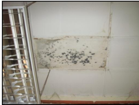
Kesan Resapan Air Di Siling Bengkel Kejuruteraan Elektrik
