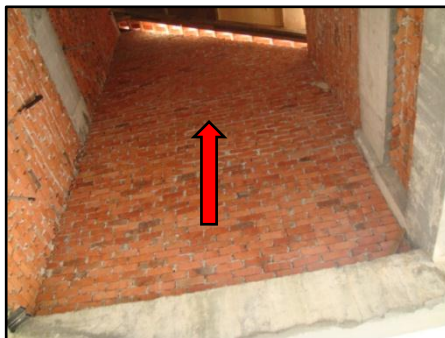
Dinding Bata Tanpa Horizontal Stiffener Di Bangunan Auditorium
