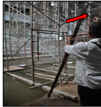
Ketinggian Paras Air Bertakung Di Orchestra Pit Setinggi 1500mm
