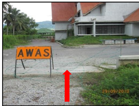
Keadaan Tapak Pembinaan Tidak Dikawal Dan Dipagar Dengan Kemas Semasa Lawatan Audit Pada 29.09.2010
