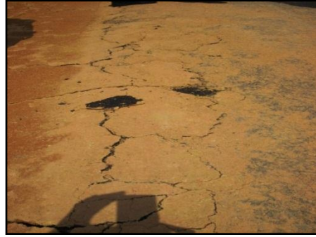
Permukaan Jalan Yang Telah Rosak Di Kilometer 52.5
