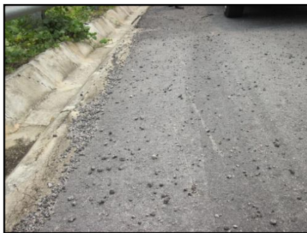
Batu Kerikil Dan Pasir Di Atas Permukaan Jalan Tidak Dibersihkan
