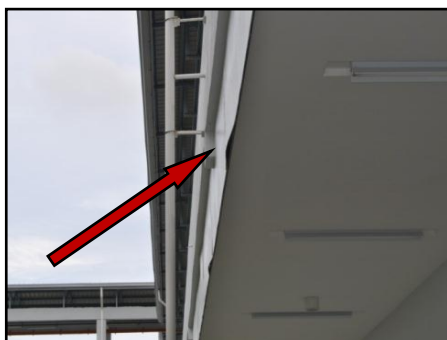
Keadaan Lapisan Papan Simen Mengembang Di Bangunan Fakulti Kejuruteraan Mekanikal
