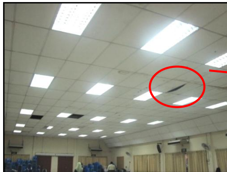
Siling Bocor Di Dewan Serbaguna
