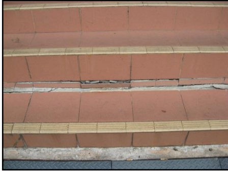
Keretakan Pada Tangga Kantin
