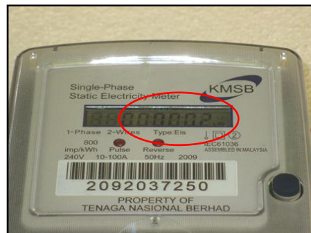
Bacaan Meter Hanya 2 Watt Semasa Lawatan Audit Pada 30.09.2011
