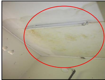
Kebocoran Pada Atap Rumah Menyebabkan Air Meresap Ke Siling Di Besut, Terengganu
