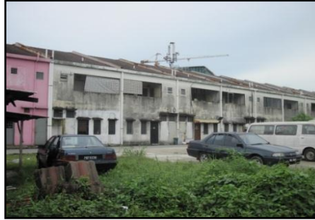
Keadaan Cat Dinding Bangunan Kedai Yang Pudar Di Taman Pelangi
