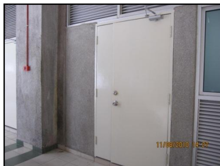
Pintu Utama Ke Bilik Server
