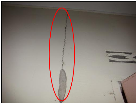
Keretakan Di Dinding Rumah Di Seberang Tayur Hulu, Kemaman
