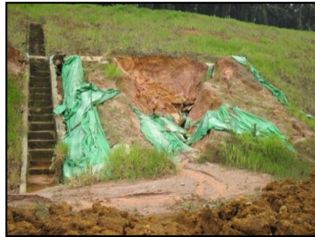
Bahagian Cerun Yang Mengalami Tanah Runtuh Di Kilometer 5 Dari Pasir Gudang Arah Ke Cahaya Baharu
