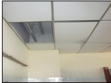
Siling Tandas Yang Tertanggal Di Bangunan Kelas Jahitan
