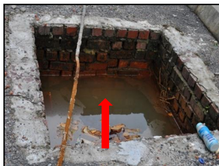
Keadaan Lubang Kumbahan Yang Tidak Ditutup Dengan Sempurna Semasa Lawatan Audit Pada 29.09.2010
