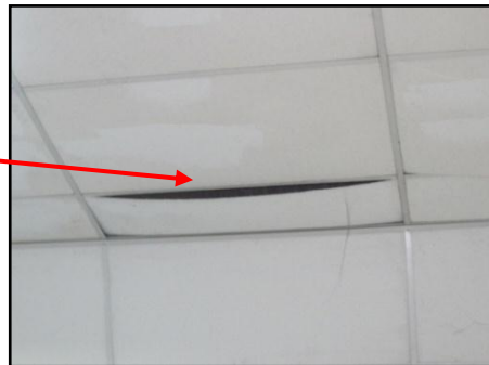
Siling Bocor Di Dewan Serbaguna
