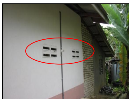
Tingkap Ram Kaca Tetap Digantikan Dengan Batu-Bata Lubang Angin
