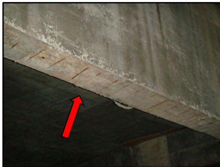
Tetulang Besi Pada Pengikat Rasuk Di Tingkat Atas Telah Berkarat Di Bangunan Auditorium
