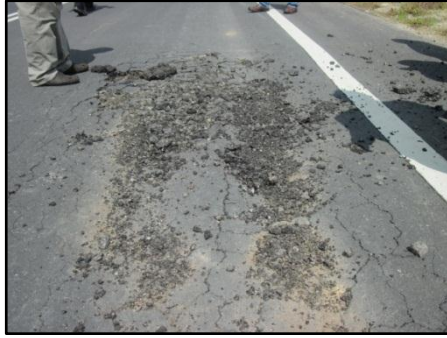
Permukaan Jalan Yang Telah Rosak Di Kilometer 50.5
