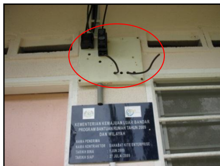
Meter Elektrik Yang Dicuri
