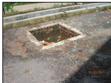
Keadaan Lubang Kumbahan Masih Tidak Ditutup Semasa Lawatan Susulan Pada 31.03.2011
