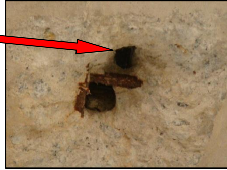
Tetulang Besi Terdedah Dan Berkarat Di Bangunan Auditorium
