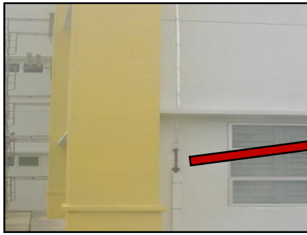
Pengalir Perlindungan Kilat Jenis Aluminium Di Bangunan Fakulti Kejuruteraan Mekanikal
