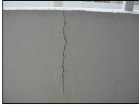
Keretakan Pada Koridor Bangunan di Fakulti Kejuruteraan Elektrik & Elektronik
