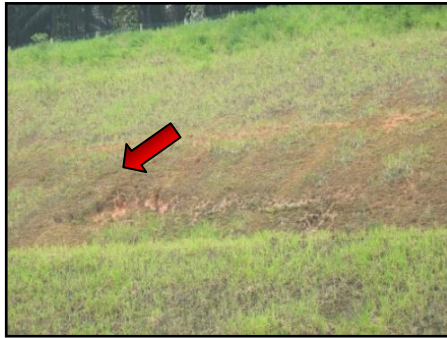
Kesan Hakisan Tanah Di Permukaan Cerun Di Kilometer 40.7
