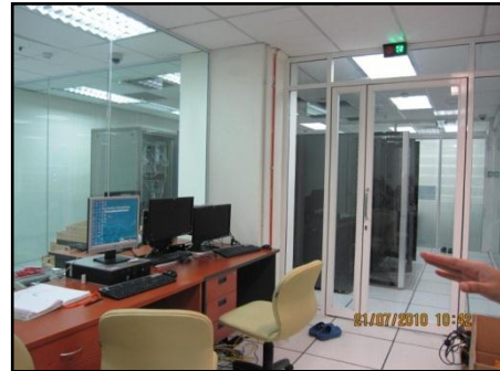
Pintu Masuk Ke Ruang Server
