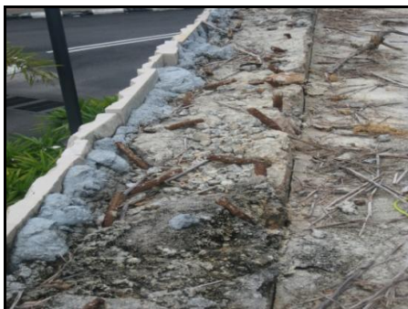
Bahagian Atas Tembok Penahan Tidak Ditutup Dengan Simen Dan Besi Cerucuk Terkeluar
