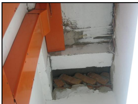
Form Work Tidak Ditanggalkan Selepas Kerja Disiapkan Dan Dinding Tidak Disimen Sepenuhnya
