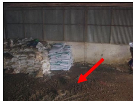
Keadaan Lantai Stor Basah Akibat Daripada Bumbung Stor Baja Yang Bocor Di Stor Penyimpanan Baja, Ladang KPSB Kemaman
