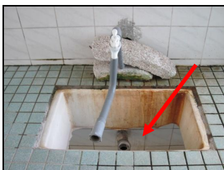
Sinki Pecah Di Bilik Air B, Blok V11E
