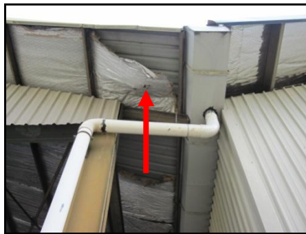
Kerosakan Penebat Haba Di Pusat Elektrik Dan Elektronik
