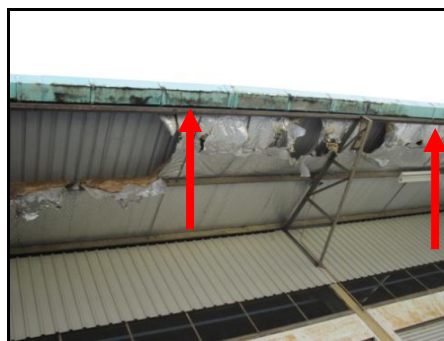
Kerosakan Rain Gutter Di Pusat Kejuruteraan Automotif
