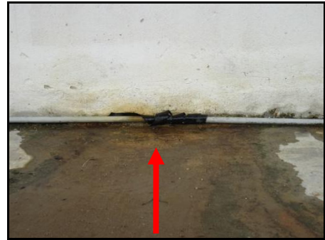
Kebocoran Paip Air Di Bengkel Mekanik Kenderaan Motor
