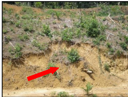
Tanah Runtuh Di Kawasan Berbukit Yang Tidak Dibuat Teres Di Kampung Keluru Jaya, Bekenu, Sarawak
