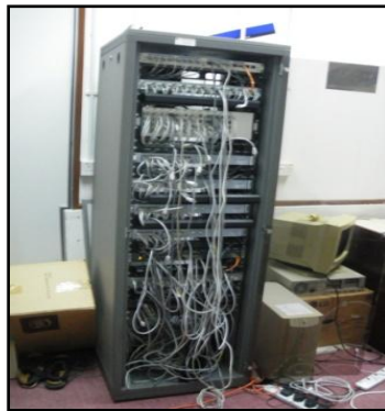
Keadaan Server Di Dalam Bilik Kampus Lama Dengan Penghawa Dingin Yang Tidak Berfungsi
