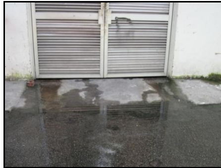
Kebocoran Paip Di Bengkel Logam
