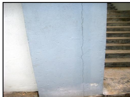
Keretakan Pada Tiang Kerangka
