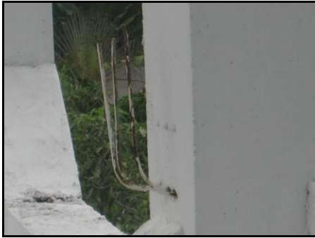
Reinforcement Steel Terkeluar Daripada Tiang Kerangka
