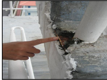
Railing Base Di Tangga Tidak Disimen Sepenuhnya Dan Berkarat
