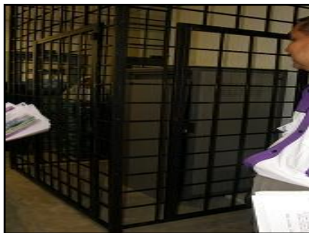
Server Diletakkan Di Koridor Yang Berjeriji Dan Terdedah
