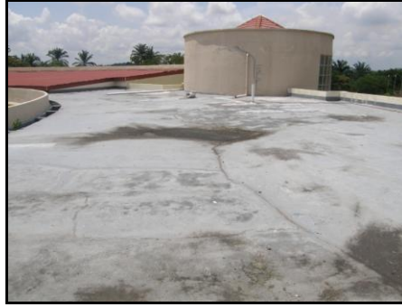
Permukaan Bumbung Rata Yang Retak Dan Terdapat Kesan Air Bertakung
