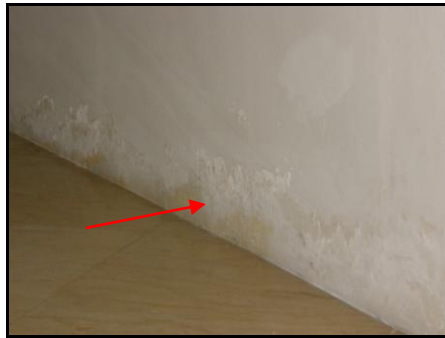
Kesan Resapan Air Di Luar Dinding Tandas, Bangunan Pentadbiran
