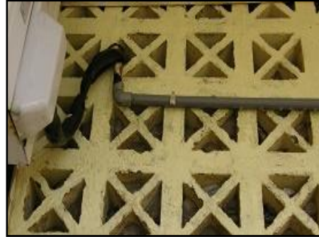
Paip Saluran Bagi Penyaman Udara Tidak Dipasang Dengan Sempurna
