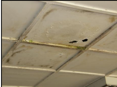
Kerosakan Di Siling Kafeteria
