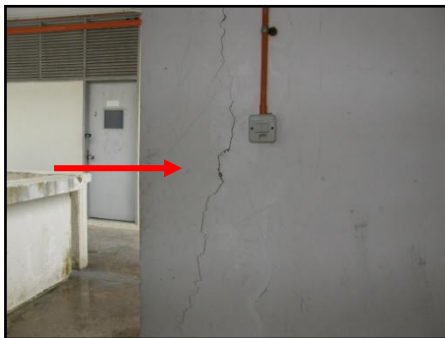
Keretakan Di Dinding Bangunan
