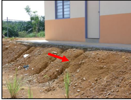
Longkang Perimeter Tidak Dibina Di Sekeliling Rumah
