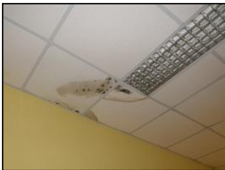
Laluan Utama/Aras 3 -Kesan Resapan Air Di Siling Berhampiran Pendawaian Lampu
