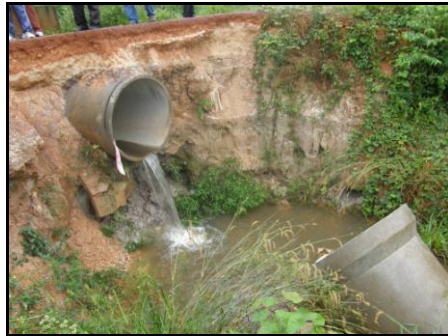
Pipe Culvert Yang Telah Terputus Dua
