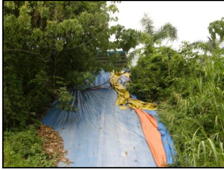
Cerun Yang Runtuh Di Tebing Jalan Ke Kawasan Asrama
