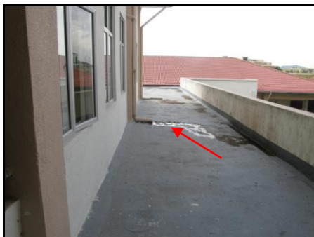
Paip Saluran Air Hujan Tidak Disambung Ke Gutter
