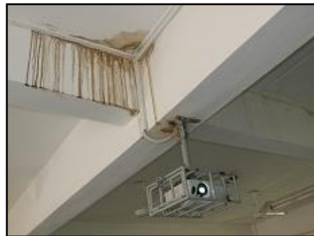
Kesan Resapan Air Di Siling Dan Rasuk Berdekatan Dengan Projektor
