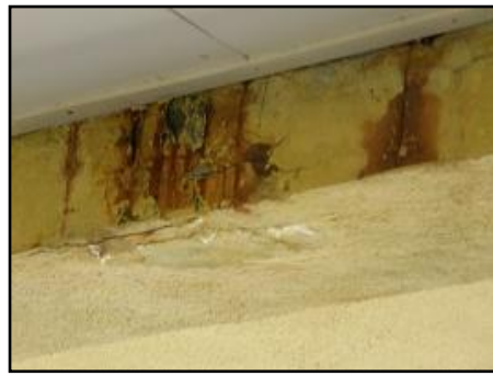
Laluan Utama Tingkat 3 - Kesan Resapan Air Menyebabkan Permukaan Rasuk Kotor
