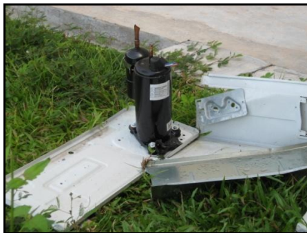
Penyaman Udara Yang Telah Rosak Dan Compressor Telah Hilang
