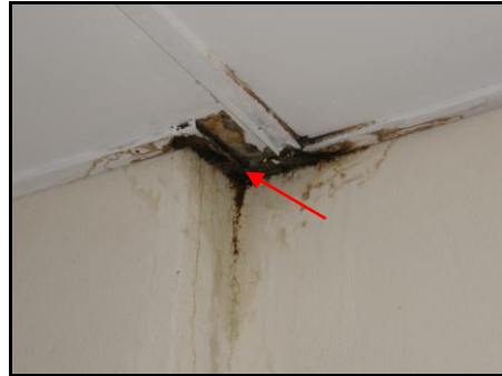
Siling Yang Rosak Dan Kotor Belum Diganti
