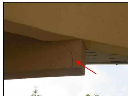
Keretakan Di Permukaan Rasuk Jalur
