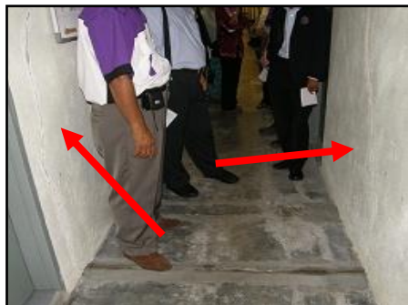
Keretakan Di Permukaan Dinding Bahagian Expansion Joint Antara Blok A Dan B
