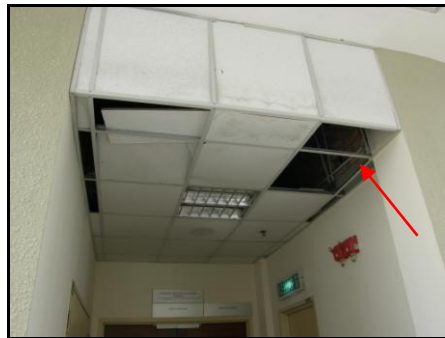
Kepingan Siling Yang Teralih Dan Jatuh Di Koridor Bahagian Pentadbiran
