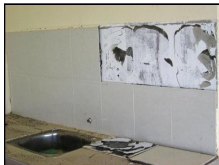
Dinding Dapur Yang Rosak
