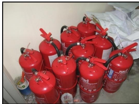
Alat Pemadam Api Yang Tidak Dipasang
