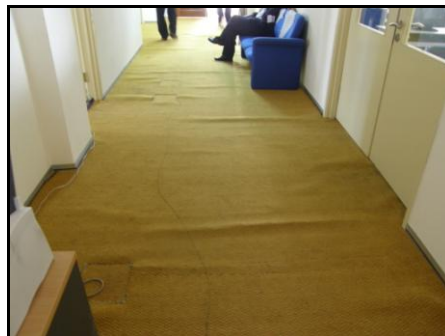
Pemasangan Karpet Yang Tidak Kemas Di Pejabat Sumber Manusia
