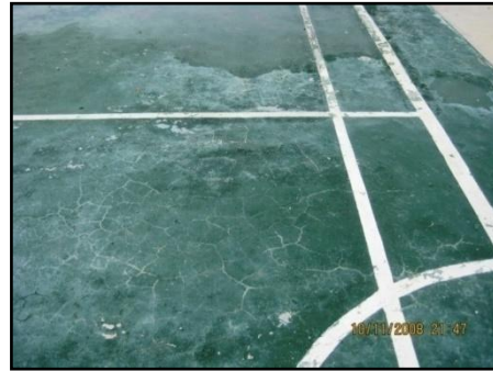
Permukaan Simen Gelanggang Sepak Takraw Yang Telah Merekah Dan Terhakis
