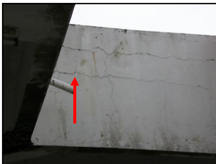
Keretakan Di Dinding Parapet
