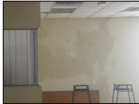
Laluan Utama/Aras 2 - Kesan resapan air di dinding bangunan
