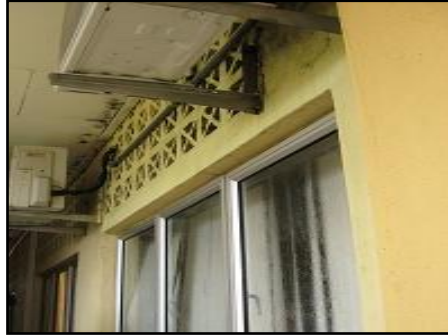
Pemeluwapan Yang Berlaku Di Dinding Luar Bilik Server
