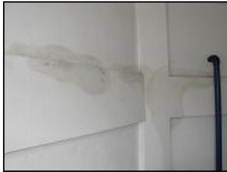
Aras 3 Berhampiran Tangga - Kesan resapan di dinding bangunan berhampiran tangga
