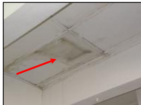
Laluan Utama Aras 3 - Kesan Resapan Air Di Siling Berpunca Daripada Lapisan Kalis Air Yang Tidak Berfungsi
