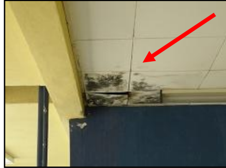
Laluan Utama -Siling Kotor, Rosak Dan Tertanggal Akibat Daripada Resapan Air
