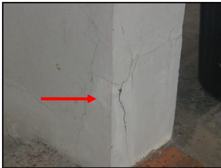
Keretakan Di Tiang Bangunan
