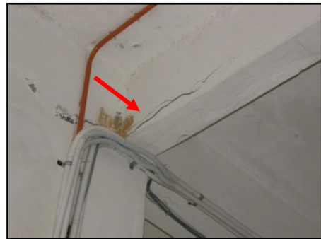
Keretakan Di Rasuk Bahagian Siling Konkrit
