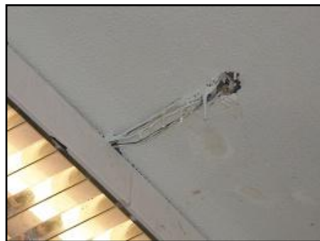
Laluan Utama/ Aras bawah -Resapan Air Berlaku Di Siling Konkrit Aras Bawah Berpunca Daripada Resapan Air Di Lantai Tingkat 1
