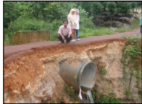
Sebahagian Jalan Telah Terhakis Dan Runtuh
