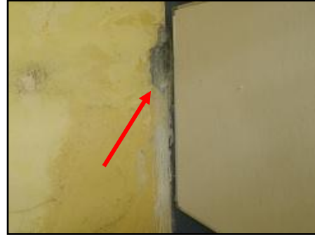
Bahagian Belakang Aras Bawah - Kretakan Pada Dinding
