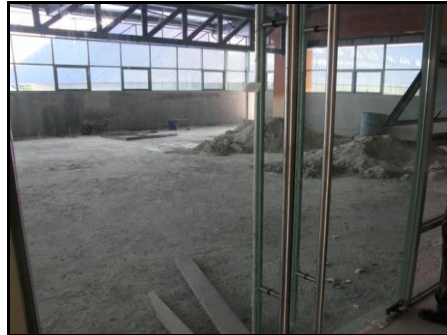
Kerja Pembinaan Dewan Serba Guna Yang Belum Disiapkan
