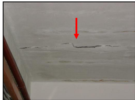
Keretakan Di Siling Konkrit
