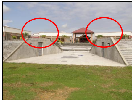
Handrailing Tidak Dipasang Di Laluan Amphitheatre
