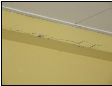
Laluan Utama Tingkat 3 - Keretakan Pada Permukaan Rasuk
