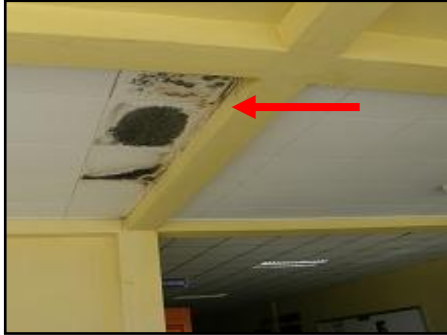
Koridor Tingkat 3 -Siling Kotor Dan Rosak Akibat Daripada Resapan Air
