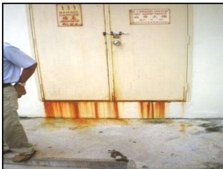
Pintu Bilik Main Switch Board Telah Berkarat
