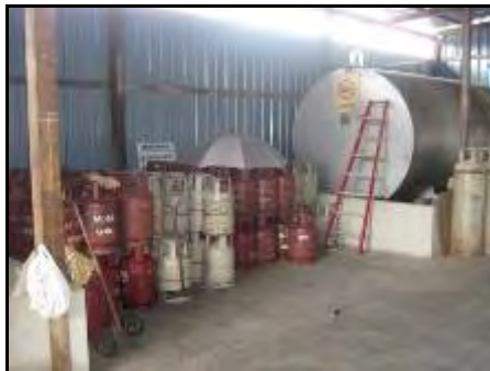
Tong Gas Memasak Berdekatan Skid Tank Di 153, Jalan Pantai, Kerian, Perak
