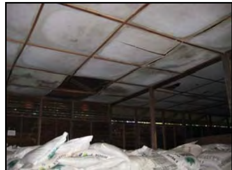
Siling Bangunan Yang Rosak Di Stor KPK Padang Terap, Kedah
