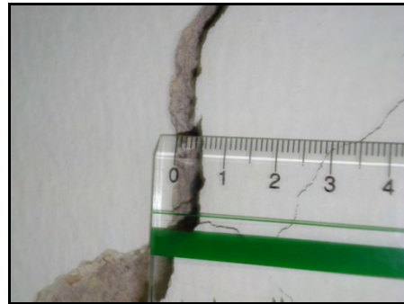
Keretakan selebar 0.5 sentimeter
