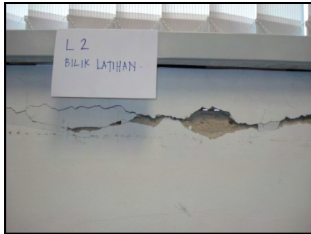
Keretakan Pada Parapet Wall
