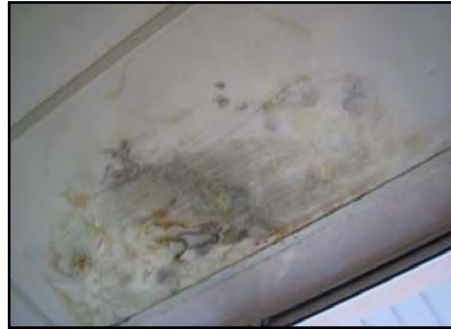
Kesan Resapan Air di Siling
