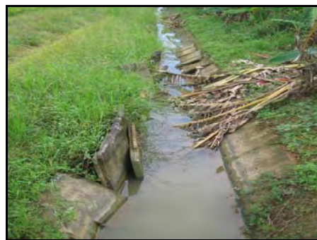
Keadaan Parit Yang Tidak Disenggara Dengan Baik
