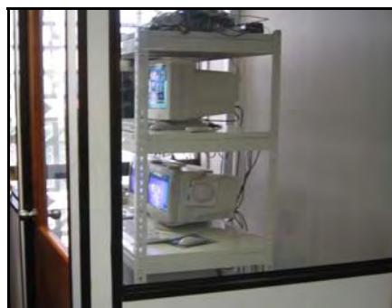
Bilik Kawalan CCTV
