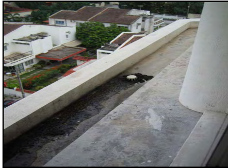
Saluran Air Yang Dilitupi Lumut
