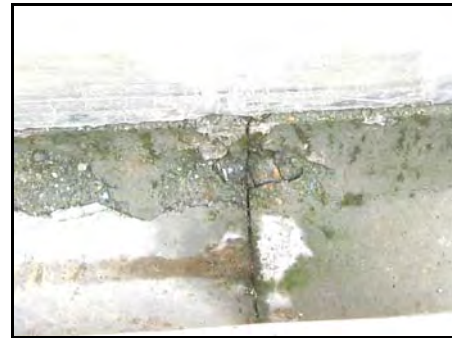
Permukaan Longkang Retak Dan Merekah
