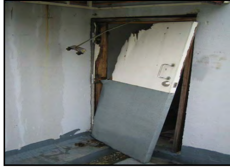
Kerangka Pintu Di Bahagian Bumbung Reput Menyebabkan Pintu Tertanggal
