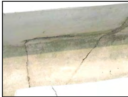
Permukaan Longkang Retak
