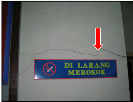
Dinding Retak Kompleks Mukah
