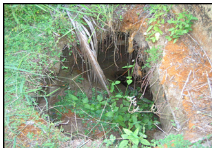
Lubang Kesan Mendapan Tanah Di Kompleks Mukah, Sarawak
