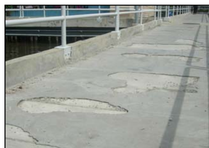
Permukaan Simen Laluan Pejalan Kaki Yang Telah Pecah
