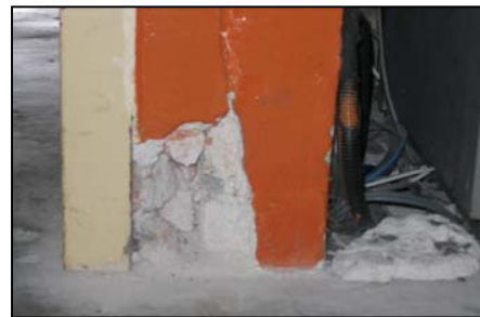
Makmal Komputer ADTEC Melaka - Retakan Besar Di Pintu Laluan Utama
