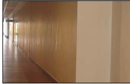
Hospital Temerloh - Dinding Bangunan Beralun Dan Tidak Rata Di Laluan Ke Jabatan Kemalangan Dan Kecemasan
