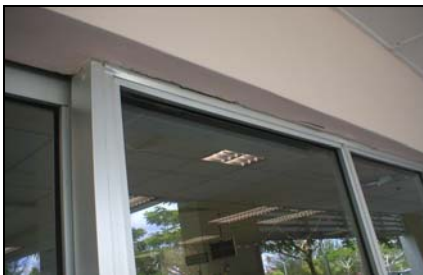
Hospital Lahad Datu - Pintu Automatik Di Klinik Pakar Tidak Dapat Berfungsi
