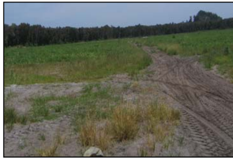
Tapak Projek Serating, Terengganu - Jalan Ladang Rosak
