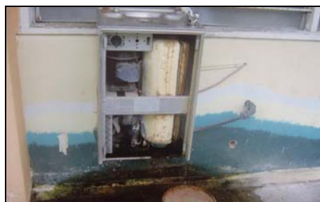
SMT Alor Setar - Water Cooler Di Luar Makmal Fizik Tidak Bertutup Dan Berbahaya
