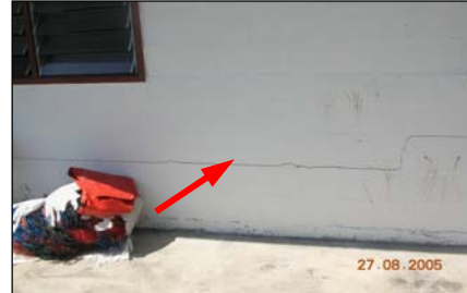
Tanjung Bungah, Pulau Pinang (Fasa I) - Keretakan Yang Berlaku Di Dinding Rumah Transit
