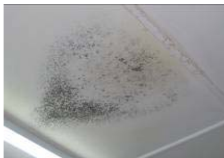
Pusat Pendidikan Komuniti, Jalan Bakau Chondong, Batu Pahat, Johor - Bumbung Bocor
