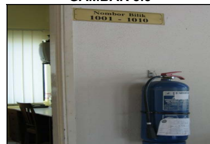
Alat Pencegah Kebakaran Dipasang Di Bilik Asrama
