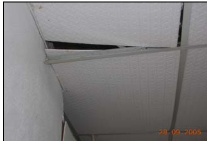
Kota Kuala Muda, Kedah - Siling Rumah Transit Yang Mengalami Kerosakan
