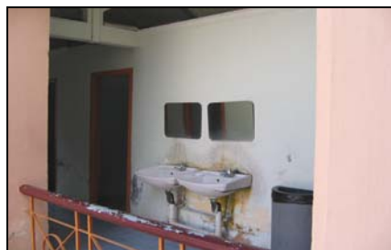
Asrama Sungai Ujung, Kolej Kejururawatan Seremban - Dinding Di Kawasan Bilik Mandi Asrama Perlu Diperbaiki
