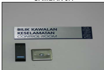
Bilik Kawalan CCTV Dan Sistem Kad Akses
