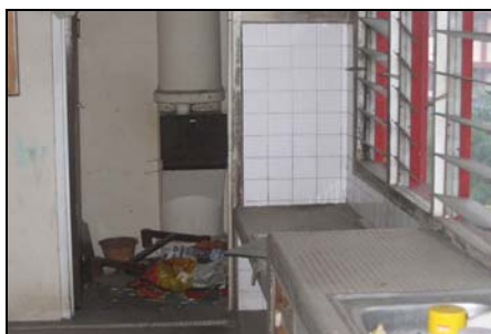
Kuarters Bomba Tangkak, Johor - Keadaan Sebuah Rumah Yang Tiada Berpenghuni Dan Tidak Diselenggara Dengan Baik
