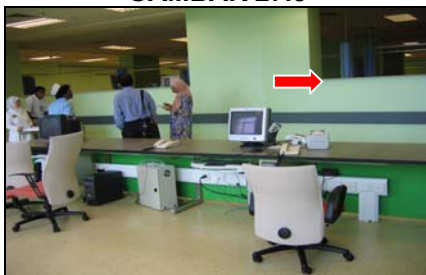
Hospital Serdang - Dinding Recovery Area Di Dewan Bedah Adalah Terlalu Tinggi
