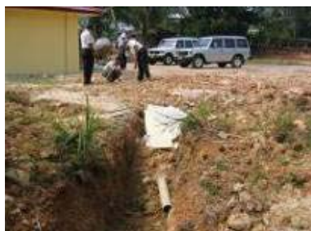
Pusat Sumber, Felcra Sri Makmur, Pahang - Air Kumbahan Yang Telah Dirawat Disalurkan Ke Kawasan Perumahan Berdekatan Tanpa Sistem Saliran Yang Baik
