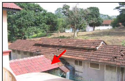
Asrama Sungai Ujung, Kolej Kejururawatan Seremban - Sebahagian Bumbung Bangunan Usang Yang Terletak Di Luar Pagar Asrama Bercantum Dengan Bumbung Asrama
