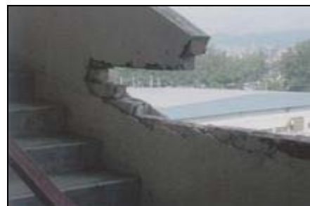
Kuarters Balai Bomba Prai - Tembok Di Sebelah Tangga Yang Mengalami Kerosakan Yang Serius
