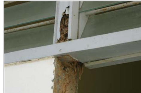
SMT Seberang Perai - Bingkai Pintu Tandas Di Blok Bengkel Dan Makmal Kejuruteraan Rosak Dimakan Anai-Anai
