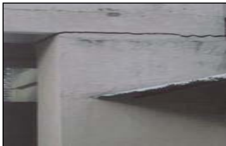
Kuarters Balai Bomba Prai - Bahagian Dinding Luar Bangunan Yang Retak
