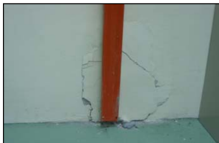
Unit Teknologi Mekatronik ADTEC Batu Pahat - Retakan Di Dinding Makmal Programmable Logic Controller
