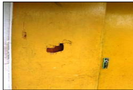
12 Rejimen Askar Melayu Di Raja Kem Daralockwood, Kuantan - Keadaan Pintu Berlubang Di Berek Bujang
