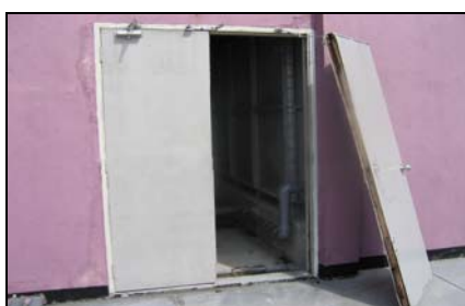
Hospital Serdang - Pintu Kayu Di Bilik Tangki Air Tidak Sesuai Dan Telah Rosak
