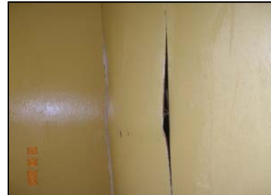
Kota Kuala Muda, Kedah - Dinding Plywood Rumah Transit Yang Telah Terkopak
