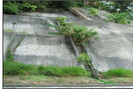
Kilometer 2.00 - Pokok-Pokok Yang Tumbuh Dalam Cascade Drain Tidak Dibersihkan Boleh Menyebabkan Pengaliran Air Tersekat
