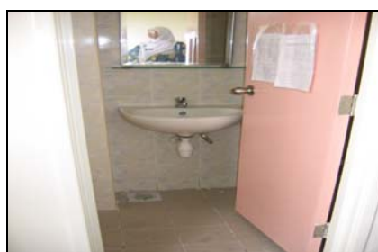
Hospital Jasin - Bilik Air Di Kuarters Kelas D, Sempit, Pintu Terkena Sinki Jika Dibuka
