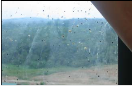
Hospital Temerloh - Kesan Sisa Bahan Binaan Di Tingkap Wad Lelaki Tidak Dibersihkan
