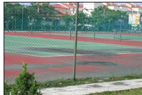
SMT Seberang Perai - Gelanggang Tenis Yang Rosak Akibat Air Bertakung
