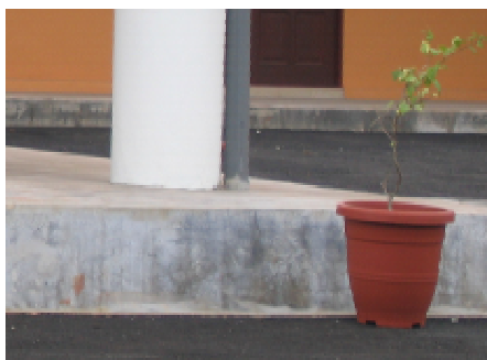
Pusat Pendidikan Awal Kanak-Kanak, Kg. Balok, Kuantan, Pahang - Siar Kaki Bangunan Lebih Tinggi Daripada Dataran Kejut
