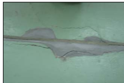
Unit Teknologi Mekatronik ADTEC Batu Pahat - Retakan Di Lantai Makmal Sensor
