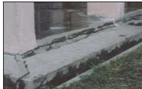
Kuarters Balai Bomba Prai - Bahagian Balkoni Longkang Yang Retak
