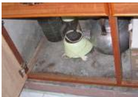
Pusat Pendidikan Komuniti, Jalan Bakau Chondong, Batu Pahat - Lantai Kabinet Tidak Dipasang Jubin
