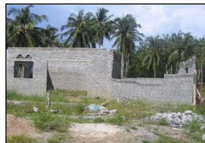
Balik Pulau, Pulau Pinang - Rumah Yang Tidak Dibaiki Sepenuhnya
