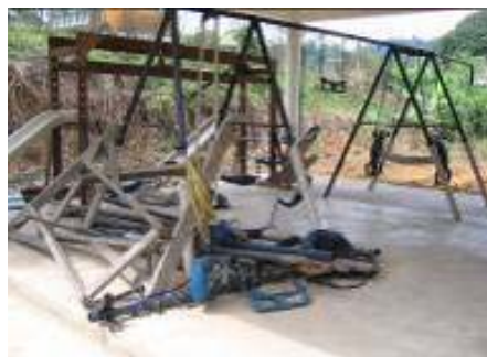
Pusat Pendidikan Awal Kanak-Kanak Di Kg. Bandar, Maran, Pahang - Peralatan Riadah Yang Dibeli Tidak Dipasang Kerana Tanah Belum Diturap
