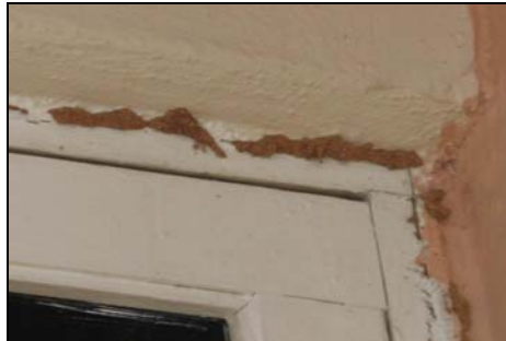
SMT Kuala Selangor - Bingkai Pintu Dan Tingkap Dewan Serbaguna Dimakan Anai-Anai
