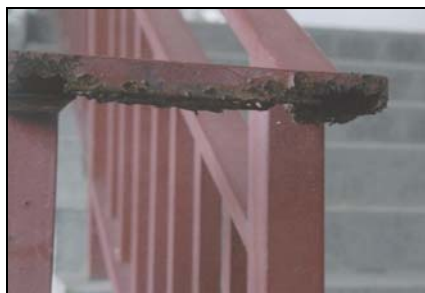
Kuarters Balai Bomba Prai - Struktur Besi Yang Berkarat
