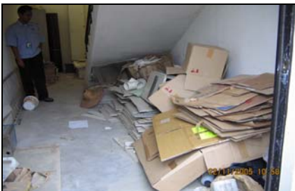
Hospital Setiu - Sisa Bahan Binaan Masih Belum Dibersihkan Di Kawasan Loji Walaupun Tempoh Tanggungan Kecacatan Sudah Tamat
