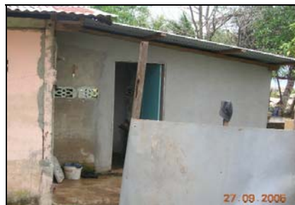
Kota Kuala Muda, Kedah - Bilik Air Yang Rosak Di Sebuah Rumah Tidak Dibaiki
