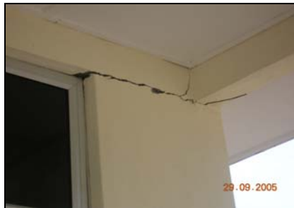
Kuala Teriang, Pulau Langkawi - Keretakan Yang Berlaku Pada Struktur Rumah
