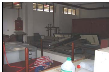
Kuarters Bomba Damansara, Selangor - Keadaan Bilik Pam Di Yang Dipenuhi Dengan Barangan Yang Tidak Disusun Rapi
