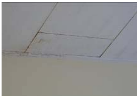
Pusat Sumber, Taman Sri Lambak, Tenggara, Johor - Bumbung Bocor
