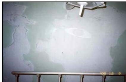
Hospital Jasin - Cat Dinding Terkopek Di Sebahagian Dinding Dalam Bangunan
