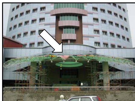
Skylight Roof Yang Belum Siap
