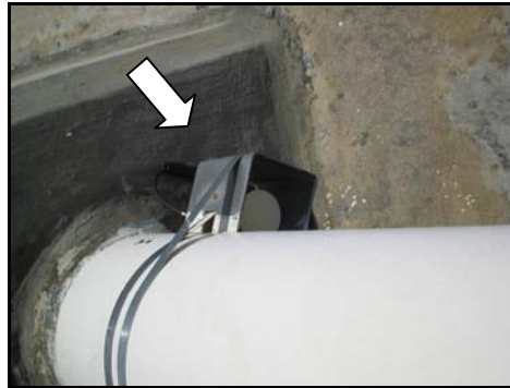
Alat Yang Membolehkan Struktur Jambatan Pulau Pinang Bahagian Kabel Diawasi 24 Jam
