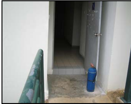
Alat Pencegah Kebakaran Dijadikan Penahan Pintu
