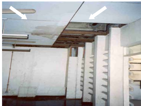
Kerosakan siling di bilik rehat yang tidak bertutup di bilik rehat
