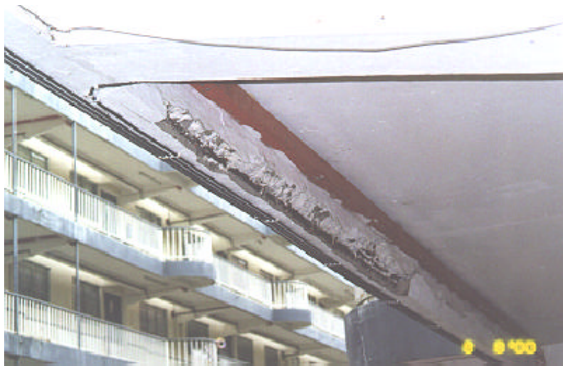
Lokasi : Perumahan PDRM Taman Nelly, Kota Kinabalu, Sabah Keadaan Rumah : Konkrit Pada Siling Pecah Dan Retak Tarikh Dibeli : Mei 1995
