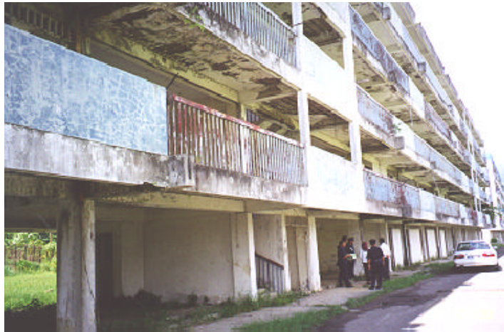
Lokasi : Perumahan Ibu Pejabat Polis Kontinjen Sabah, Kota Kinabalu Keadaan Rumah : Kerosakannya Tidak Ekonomi Dibaiki Dan Perlu Dirobohkan
