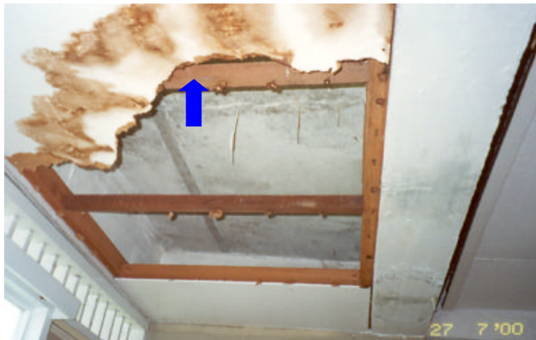
Siling Runtuh Disebabkan Oleh Resapan Air Di Markas Garison Kem Terendak Melaka
