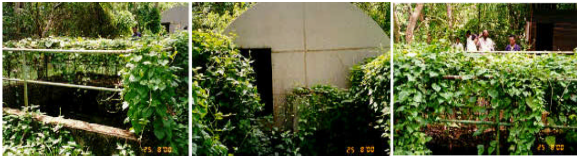
Keadaan Sistem Kumbahan Di Pantai Batu Manikar Resort, Pulau Labuan Yang Tidak Pernah Dilawati Oleh JAS Negeri Sabah
