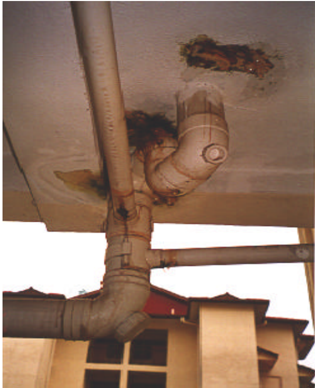
Lokasi : Penjara Pokok Sena, Kota Setar, Kedah Keadaan Rumah : Saluran Paip Kumbahan Bocor
