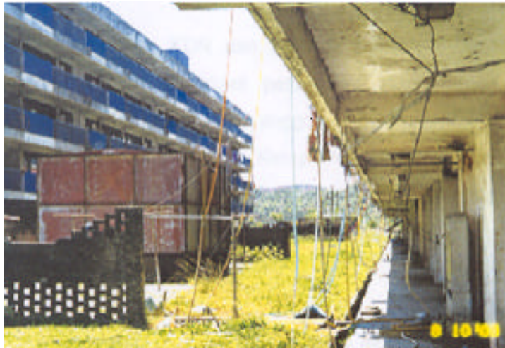
Lokasi : Perumahan Ibu Pejabat Polis Daerah Lahad Datu, Sabah Keadaan Rumah : Konkrit Pada Siling Rumah Retak Dan Pecah Dan Tangki Air Tidak Berfungsi
