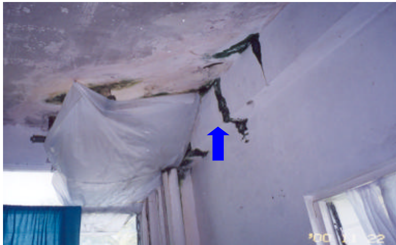
Saluran Singki Dapur Rumah Di Tingkat Atas Bocor Di Kem Lok Kawi, Sabah
