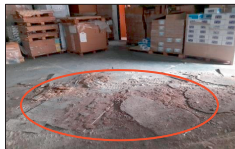
Stor Penyimpanan Bahan Siap Bercetak - Permukaan Lantai yang Pecah dan Berlubang (11.11.2018)
