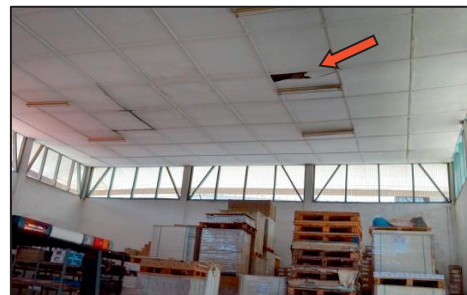
Stor Penyimpanan Kertas - Kerosakan Siling Stor (11.11.2018)
