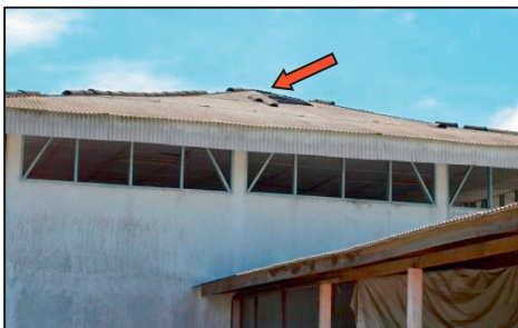
Stor Penyimpanan Kertas - Kerosakan Struktur Bumbung Stor (11.11.2018)
