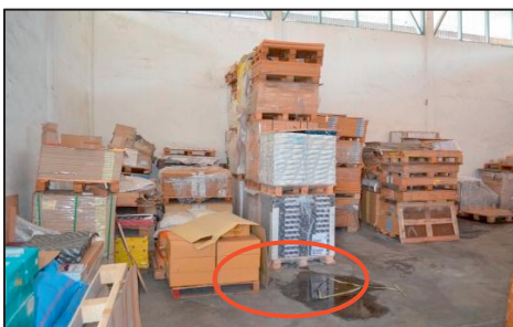
Stor Penyimpanan Kertas - Air Bertakung di Lantai Akibat Kerosakan Bumbung (11.11.2018)
