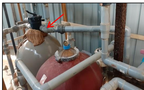
Penapis Air Kolam Renang - 1 Unit Bocor dan tidak berfungsi (24 Julai 2019) (Sumber: Jabatan Audit Negara)
