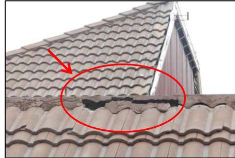
Struktur Bangunan - Kebocoran di Bumbung Blok Garden Wing (23 Julai 2019) (Sumber: PRIMULA)
