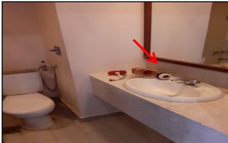
Tandas di Bilik Garden Wing - Kerosakan Paip dan Sinki (23 Julai 2019) (Sumber: Jabatan Audit Negara)
