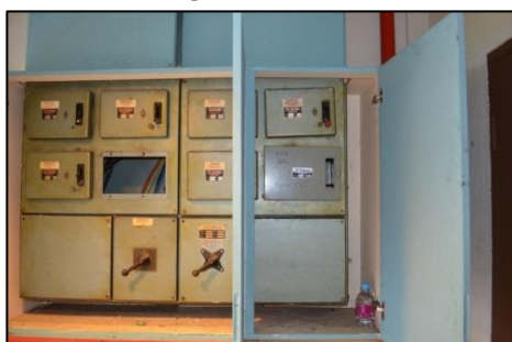
Sistem Voltan Rendah LV - Main Switch Board uzur dan usang (23 Julai 2019) (Sumber: Jabatan Audit Negara)
