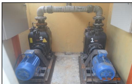
Tapak Pelupusan Sisa Pepejal MDB - Pam Motor Kolam Air Resapan ( Leachate ) Rosak (24.04.2018)
