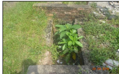
Taman Desa Tanjung - Longkang Tidak Dibersihkan (24.04.2018)
