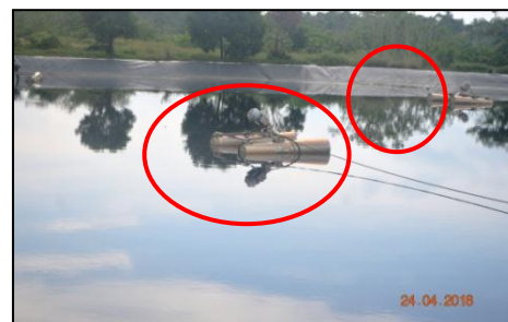
Tapak Pelupusan Sisa Pepejal MDB - Aerator di Kolam Air Resapan ( Leachate ) Tidak Berfungsi (24.04.2018)
