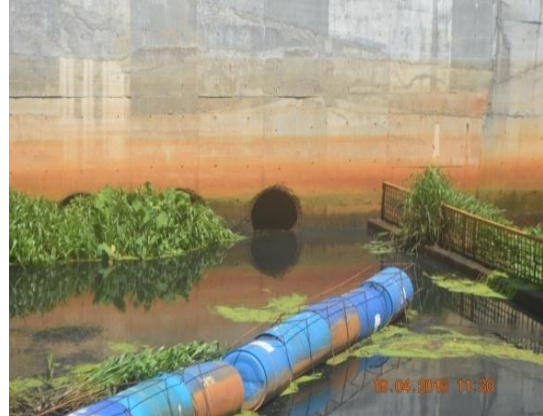
Gambar 1.9 Tadahan Air Yang Tidak Di Senggara
