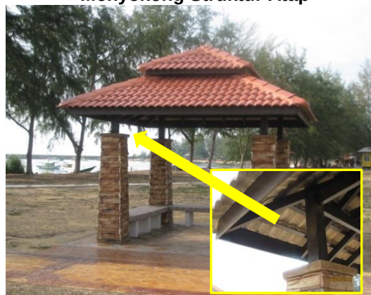
Gambar 3.6 Palang Penahan Tidak Dipasang Bagi Menyokong Struktur Atap
