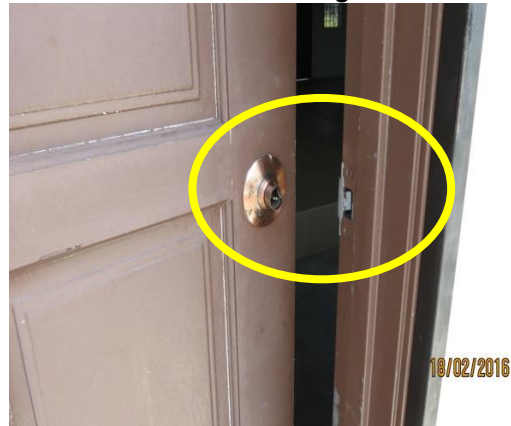
Gambar 4.24 Pintu Dewan Yang Rosak
