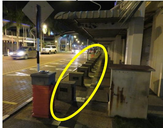
Gambar 3.16 Lampu Bollards Tidak Menyala/Berfungsi
