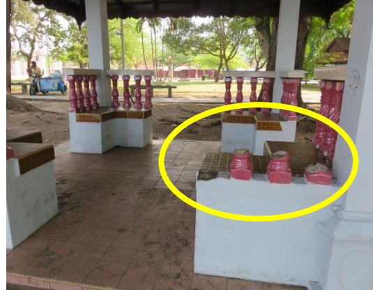
Gambar 3.8 Keretakan Pada Jeriji Wakaf
