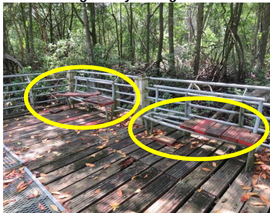
Gambar 3.11 Bangku Kayu Yang Rosak
