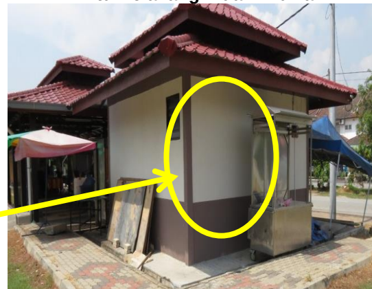
Gambar 4.6 Pintu Belakang Tidak Dibina
