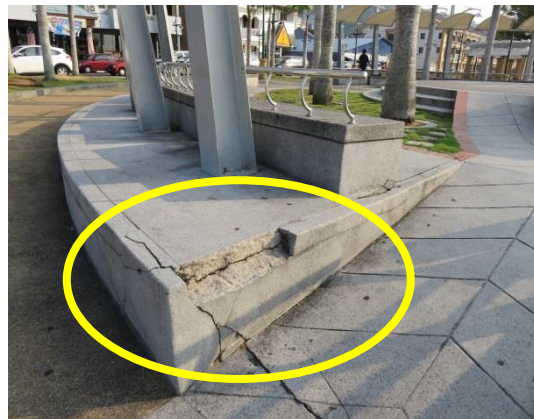
Gambar 3.6 Keretakan Pada Lantai Konkrit
