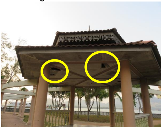
Gambar 3.5 Siling Wakaf Rosak Dan Bocor
