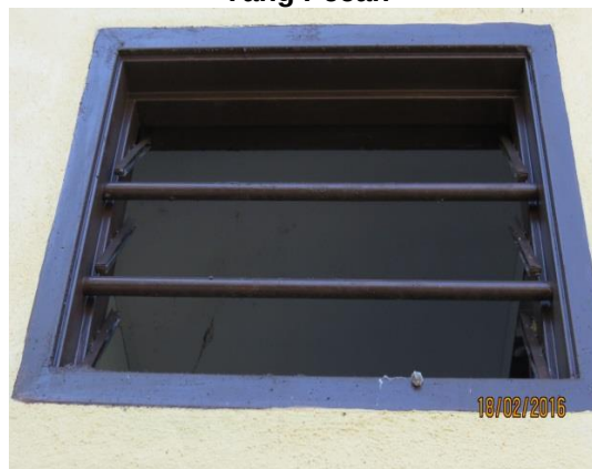
Gambar 4.22 Tingkap Ruang Udara Tandas Yang Pecah
