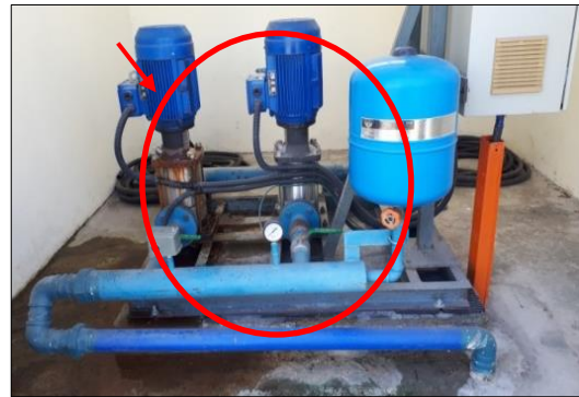
Bilik Pam, Garaj Cuci Kenderaan, Kem 31 RAD Kajang - Terdapat Kebocoran Pada Pam Air (05.12.2019) (Sumber: Jabatan Audit Negara)
