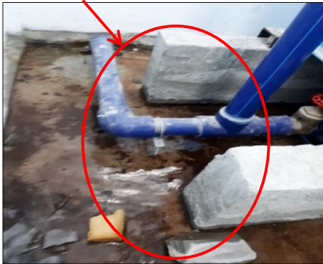
Bilik Tangki, Kuarters Blok F, Kem 31 RAD Kajang - Berlaku Limpahan Pada Tangki Air Domestik (05.12.2019) (Sumber: Jabatan Audit Negara)
