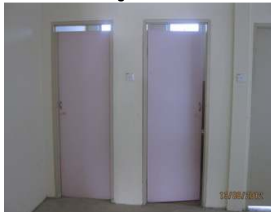
Gambar 3.38 Pintu Tidak Sama Tinggi Dengan Bingkai Pintu
