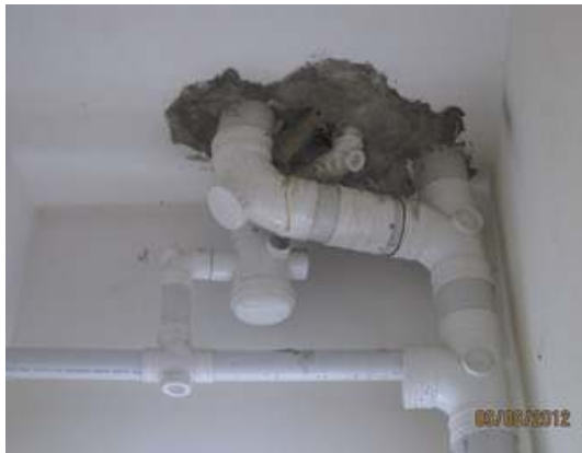
Gambar 3.17 Permukaan Siling Konkrit Tidak Diratakan Dan Tidak Dicat
