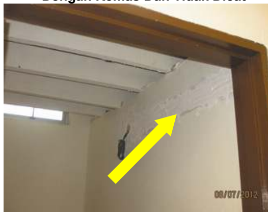
Gambar 3.26 Permukaan Dinding Tidak Dilepa Simen Dengan Kemas Dan Tidak Dicat
