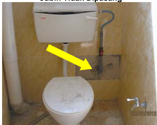
Gambar 3.20 Jubin Tidak Dipasang
