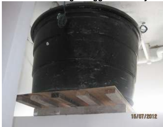
Gambar 3.41 Tangki Air Dengan Kapasiti Muatan 250 Gelen Disokong Menggunakan Kayu
