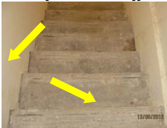
Gambar 3.37 Anak Tangga Tidak Dipasang Nosing Tiles Dan Susur Tangga
