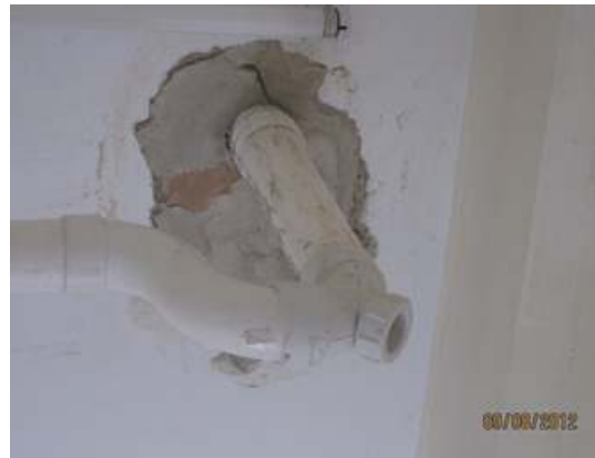
Gambar 3.18 Lepaan Simen Pada Permukaan Siling Tidak Rata Dan Tidak Dicat
