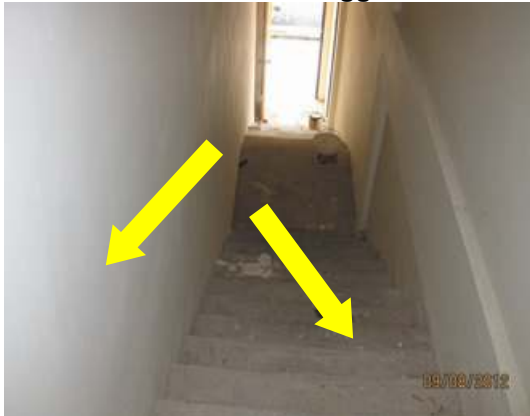
Gambar 3.39 Anak Tangga Tidak Dipasang Nosing Tiles Dan Susur Tangga
