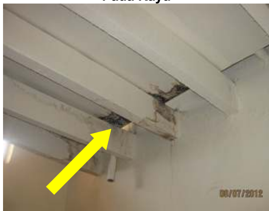
Gambar 3.25 Kesan Resapan Air Dan Kulat Pada Kayu
