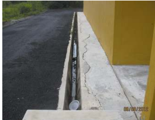
Gambar 3.16 Keretakan Pada Apron
