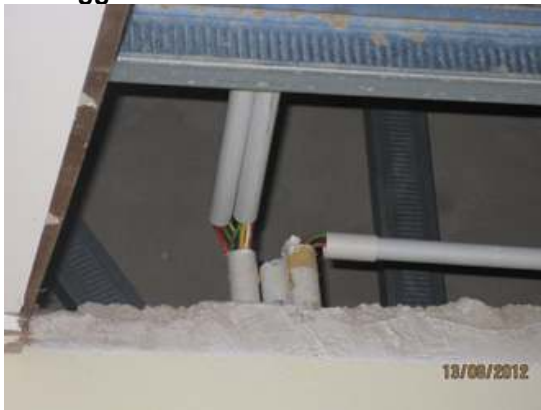
Gambar 3.35 Penyambungan Konduit Tidak Menggunakan Aksesori Alat Tambahan
