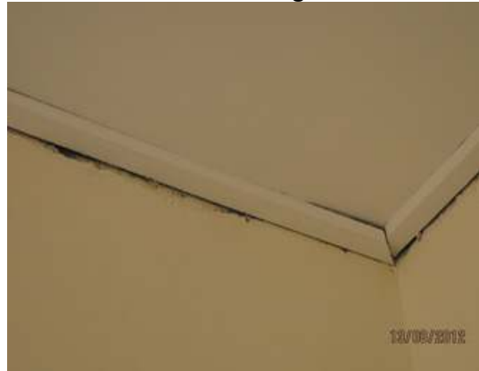
Gambar 3.14 Siling Dipasang Tidak Rapat Ke Dinding
