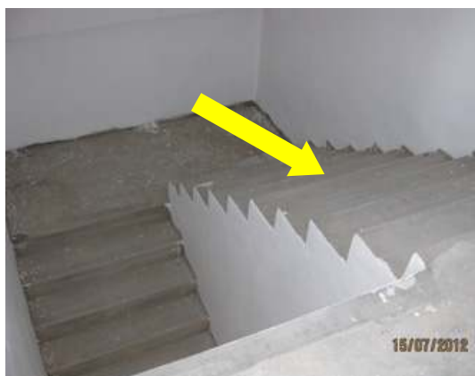
Gambar 3.43 Anak Tangga Tidak Dipasang Nosing Tiles
