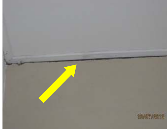
Gambar 3.8 Siling Dipasang Tidak Rapat Ke Dinding
