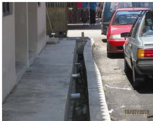
Gambar 3.22 Binaan Longkang Tidak Lurus
