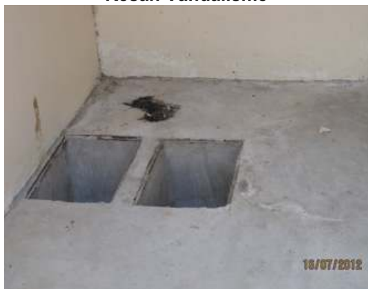
Gambar 3.50 Penutup Tangki Septik Hilang Kesan Vandalisme
