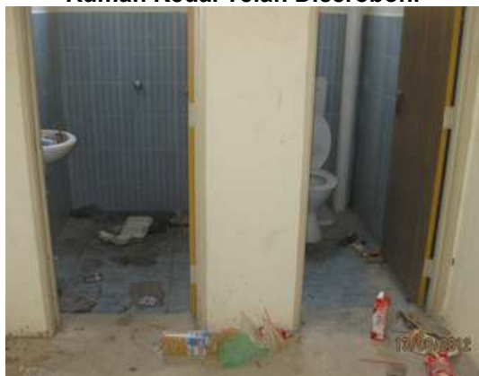
Gambar 3.48 Rumah Kedai Telah Dicerobohi
