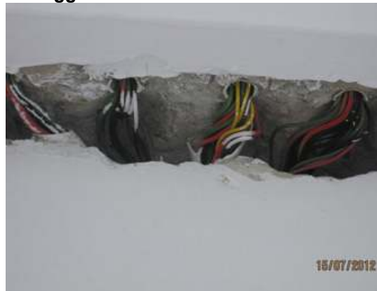
Gambar 3.42 Penyambungan Konduit Tidak Menggunakan Aksesori Alat Tambahan
