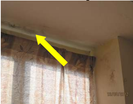
Gambar 3.15 Kesan Resapan Air Pada Siling Dan Dinding
