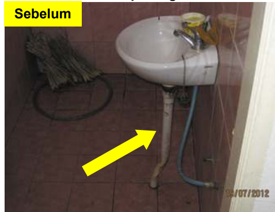
Gambar 3.27 Perangkap Sink Tidak Dipasang Dan Paip Bengkok
