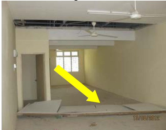
Gambar 3.13 Sebahagian Siling Rumah Kedai Yang Runtuh
