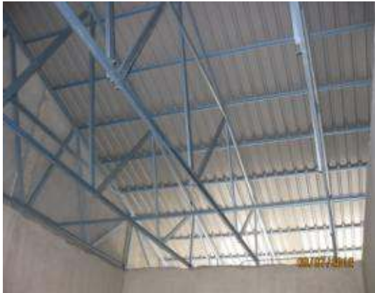
Gambar 3.33 Insulation Sheets Tidak Dipasang
