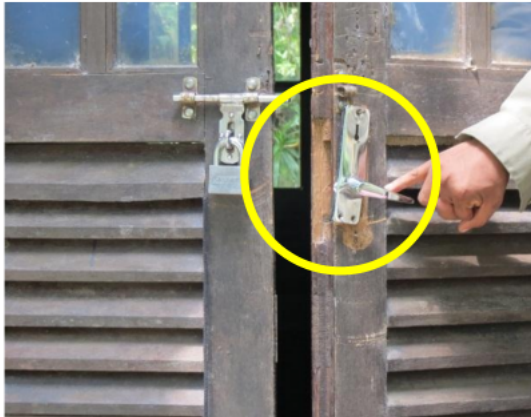
Gambar 2.18 Kunci Pintu Chalet Rosak
