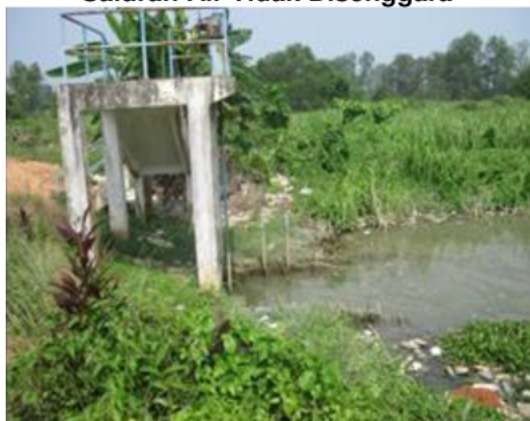
Gambar 3.4 Saluran Air Tidak Disenggara
