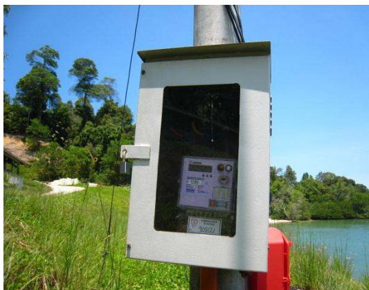
Gambar 2.13 Meter Bacaan Penggunaan Elektrik
