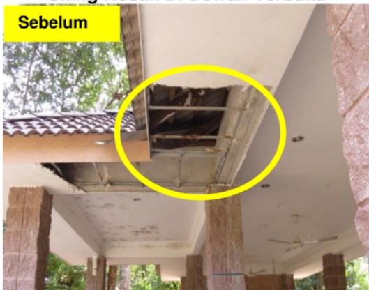
Gambar 2.26 Siling Rosak Di Dewan Terbuka
