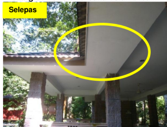
Gambar 2.27 Siling Di Dewan Terbuka Telah Dibaiki
