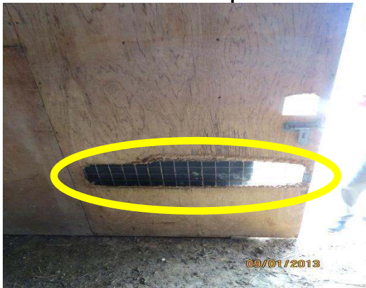
Gambar 2.17 Pintu Rumah Gelap Rosak
