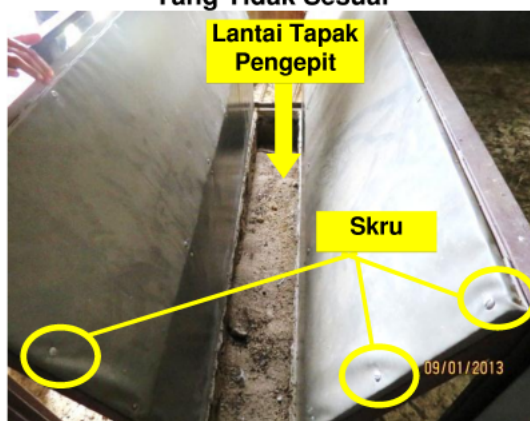
Gambar 2.13 Pembinaan Pengepit Yang Tidak Sesuai
