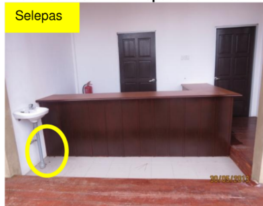
Gambar 3.8 Kabinet Rosak Dan Reput Telah Dibaiki
