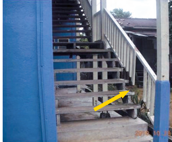
Gambar 7.8 Struktur Tangga Tidak Kukuh Dan Rosak
