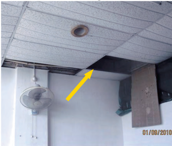
Gambar 3.13 Kerosakan Siling Kuarters
