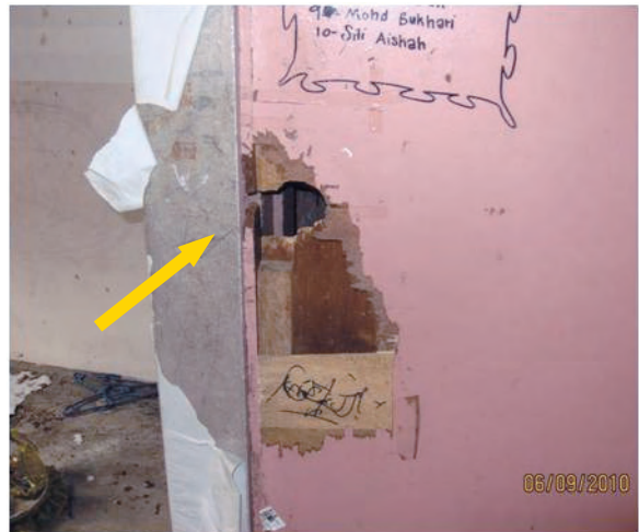
Gambar 3.16 Kerosakan Pintu Kuarters
