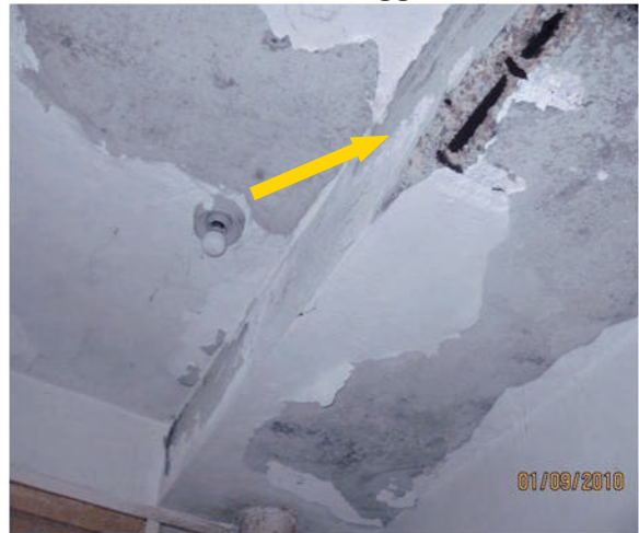
Gambar 3.14 Kerosakan Pada Sangga Kuarters
