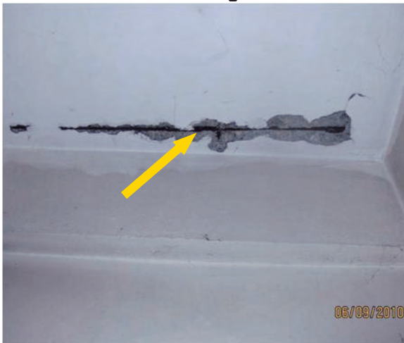
Gambar 3.15 Kerosakan Siling Kuarters
