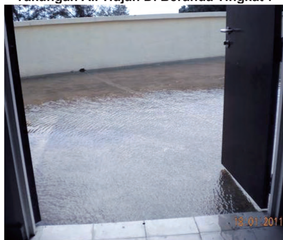
Gambar 10.5 Takungan Air Hujan Di Beranda Tingkat 7
