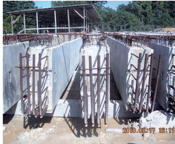
Gambar 11.2 Bahan Binaan Yang Tidak Dapat Digunakan Akibat Perubahan Reka Bentuk
