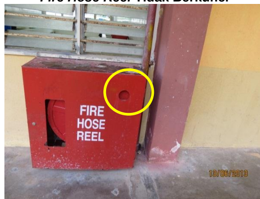
Gambar 2.53 Fire Hose Reel Tidak Berkunci
