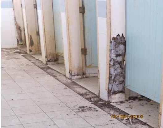
Gambar 2.27 Kerosakan Di Tandas Tidak Dibaiki
