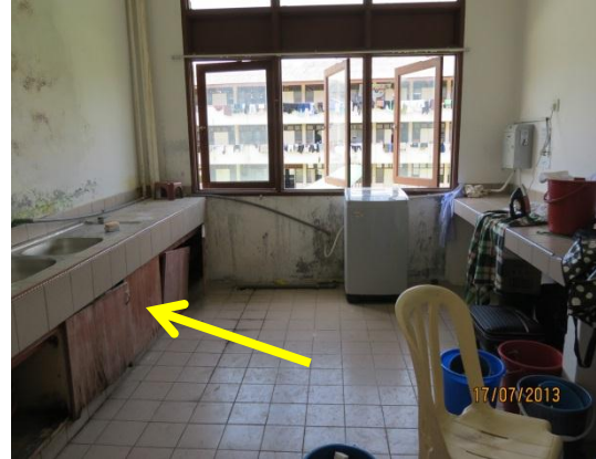
Gambar 2.32 Pintu Kabinet Di Bilik Mencuci Yang Reput Dan Rosak
