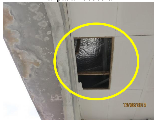
Gambar 2.40 Siling Rosak Kesan Daripada Kebocoran
