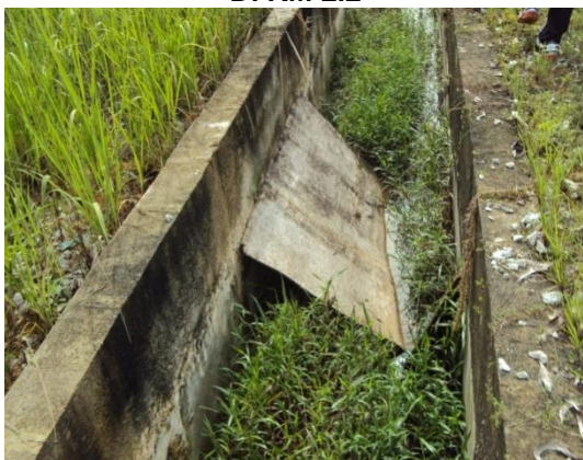
Gambar 3.7 Longkang Ditumbuhi Rumput Di KM 2.2
