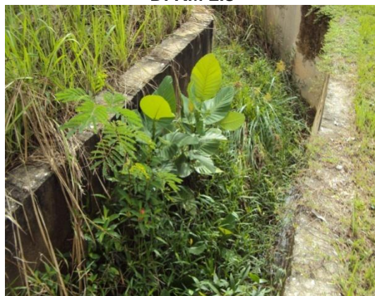
Gambar 3.8 Longkang Ditumbuhi Rumput Di KM 2.3
