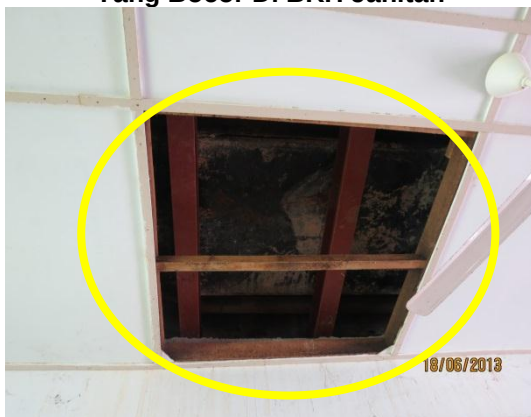
Gambar 2.9 Tangki Air Di Atas Siling Yang Bocor Di BKH Jahitan
