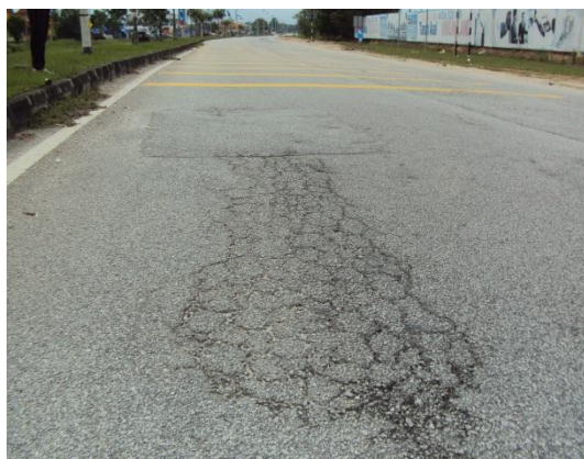
Gambar 3.3 Jalan Rosak Di KM 1.0 Bahagian Kiri
