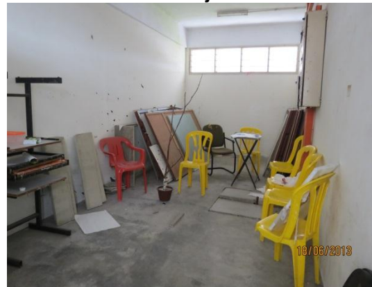
Gambar 2.34 Bilik Elektrik Dijadikan Stor
