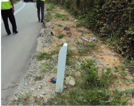
Gambar 1.11 Bahu Jalan Tidak Dirata Dan DiMampatkan
