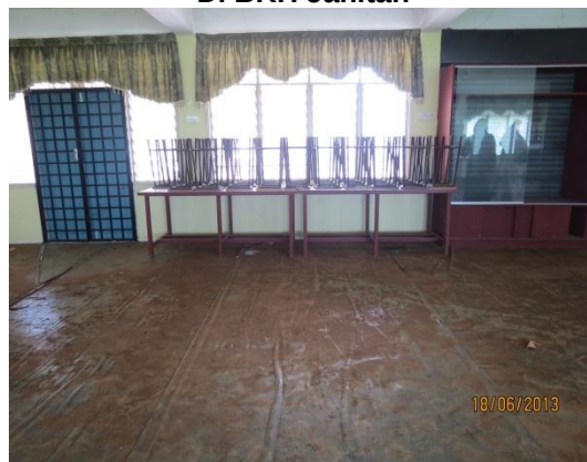
Gambar 2.10 Keadaan Lantai Yang Kotor Di BKH Jahitan
