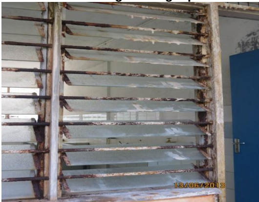
Gambar 2.17 Kesan Kebocoran Di Bahagian Tingkap
