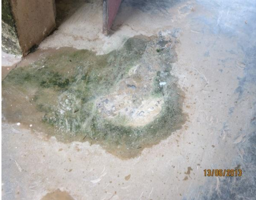
Gambar 2.19 Kesan Kebocoran Di Bahagian Lantai Bangunan Asrama
