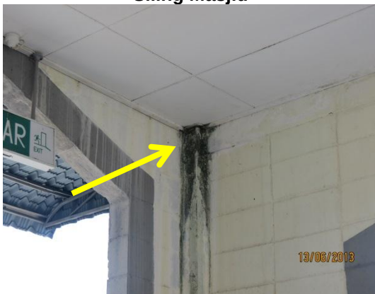
Gambar 2.39 Kebocoran Di Bahagian Siling Masjid
