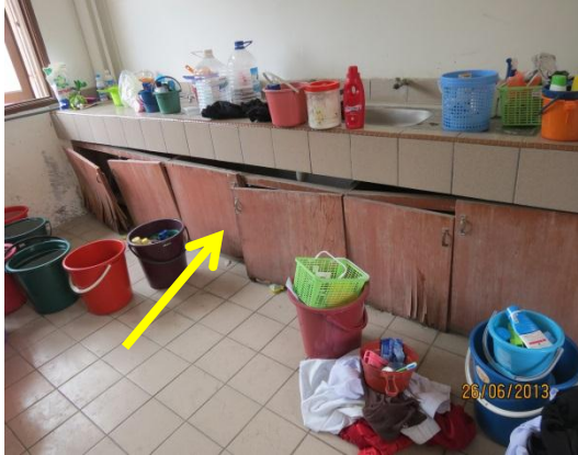
Gambar 2.31 Pintu Kabinet Di Bilik Mencuci Yang Reput Dan Rosak
