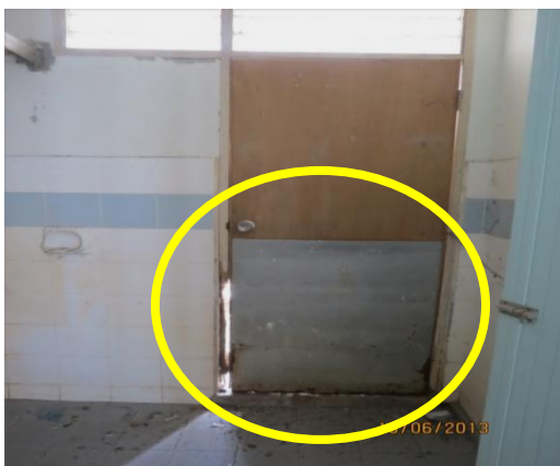
Gambar 2.49 Pintu Kuarters Telah Reput
