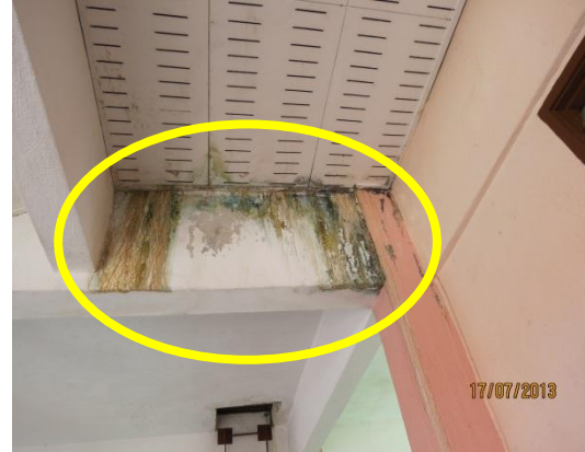
Gambar 2.20 Kesan Kebocoran Tangki Air Di Bangunan Asrama
