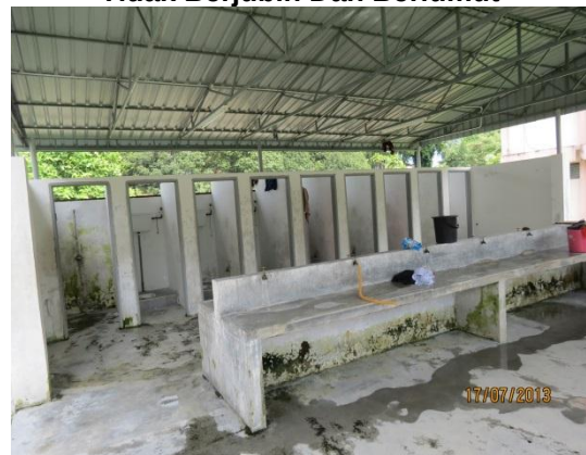
Gambar 2.30 Keadaan Tandas Tanpa Pintu, Tidak Berjubin Dan Berlumut
