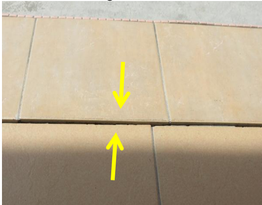
Gambar 2.37 Permukaan Lantai Anjung Yang Tidak Rata
