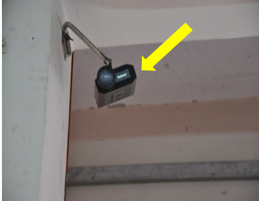
Gambar 8.13 CCTV Dipasang Tidak Berfungsi
