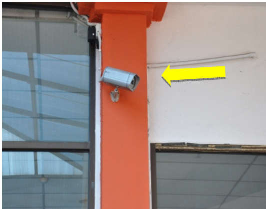
Gambar 8.15 CCTV Dipasang Tidak Berfungsi
