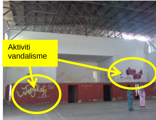
Gambar 4.5 Aktiviti Vandalisme Di Dewan Badminton
