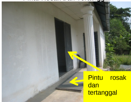
Gambar 4.2 Pintu Rosak Dan Tertanggal
