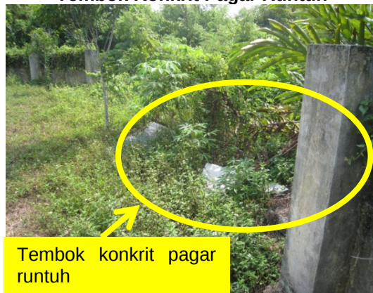
Gambar 4.3 Tembok Konkrit Pagar Runtuh
