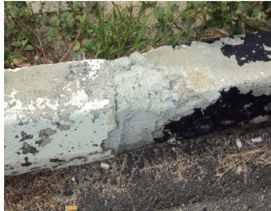
Gambar 5.9 Kerosakan Di Antara Kerb
