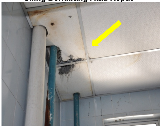
Gambar 8.1 Siling Berlubang Atau Reput
