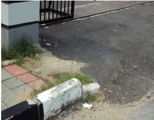
Gambar 5.8 Pemasangan Kerb Yang Tidak Kemas
