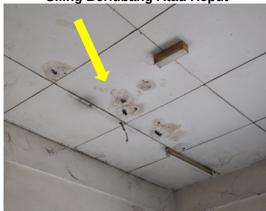
Gambar 8.2 Siling Berlubang Atau Reput
