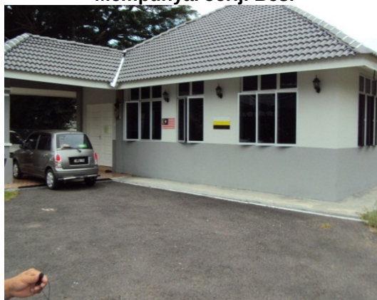
Gambar 5.33 Bahagian Hadapan TASKA Yang Tidak Mempunyai Jeriji Besi
