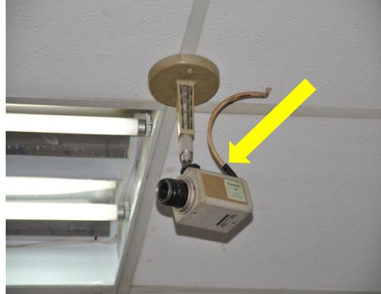
Gambar 8.14 CCTV Dipasang Tidak Berfungsi
