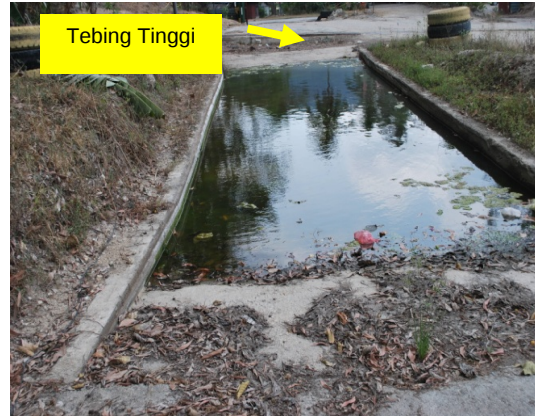
Gambar 2.19 Kolam Pencuci Tayar Tidak Berfungsi
