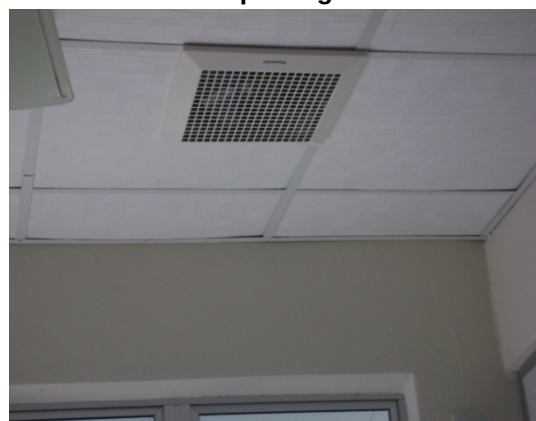
Gambar 5.2 Lokasi Baru Wall Exhaust Fan Dipasang
