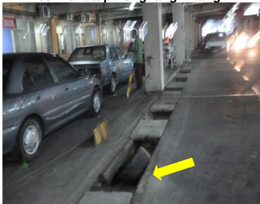
Gambar 8.8 Besi Penutup Longkang Hilang
