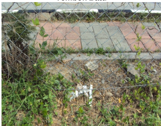
Gambar 5.14 Keadaan Pagar Yang Tidak Mempunyai Tembok Batu
