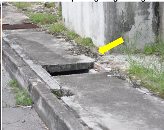
Gambar 8.9 Besi Penutup Longkang Hilang
