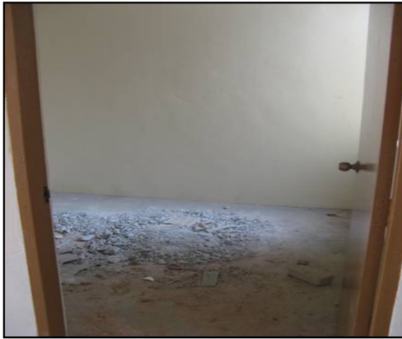
Foto 7 Sampah Binaan Tidak Dibawa Keluar
