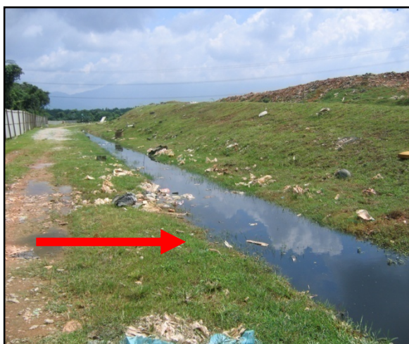
Foto 87 Air Hujan Bercampur Air Resapan Yang Mengalir Dari Cerun Tapak Bertakung Di Longkang Konkrit
