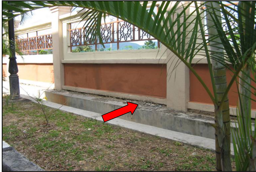
Foto 35 Kemasan Pagar Tidak Memuaskan
