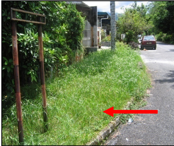
Foto 74 Rumput Tidak Dipotong
