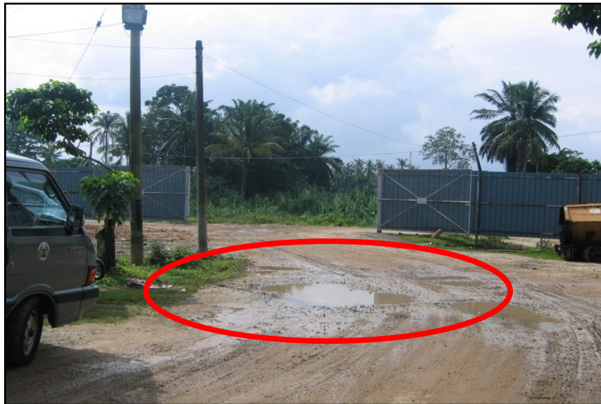
Foto 80 Jalan Masuk Ke Tapak Pelupusan Yang Berlopak
