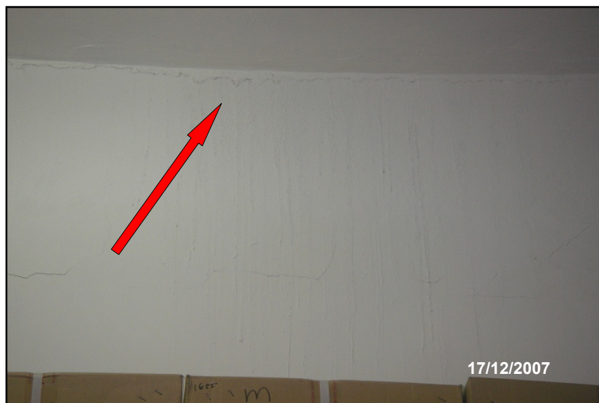
Foto 31 Siling Bilik Kebal Bocor PTD Manjung
