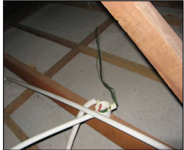
Foto 23 Pendawaian Tidak Sempurna Dan Membahayakan
