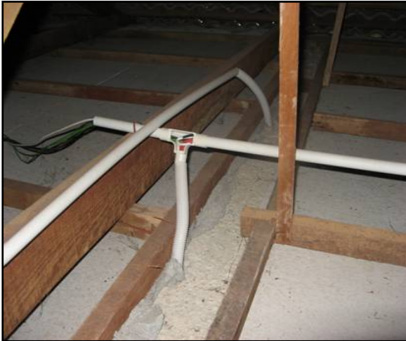
Foto 22 Pendawaian Di Ruang Siling Tidak Menggunakan Paip Besi Galvani
