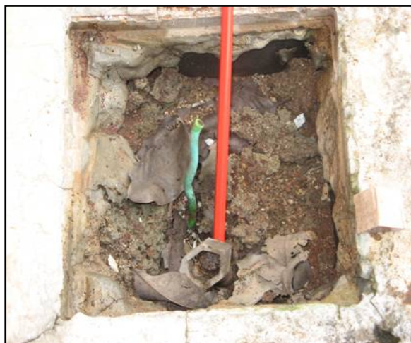
Foto 24 Saiz Kabel Bumi Tidak Mengikut Peraturan IEE
