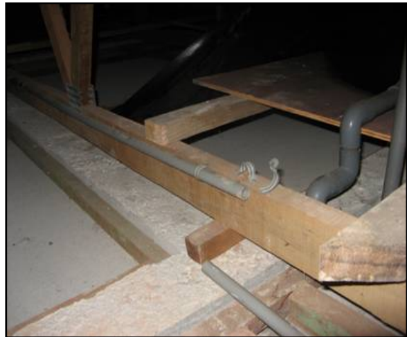
Foto 12 Kabel Di Ruang Siling Dicuri
