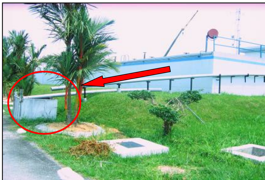
Foto 38 Pam Pasir Yang Dipasang Di Muka Sauk Loji Rawatan Air Bukit Temoh
