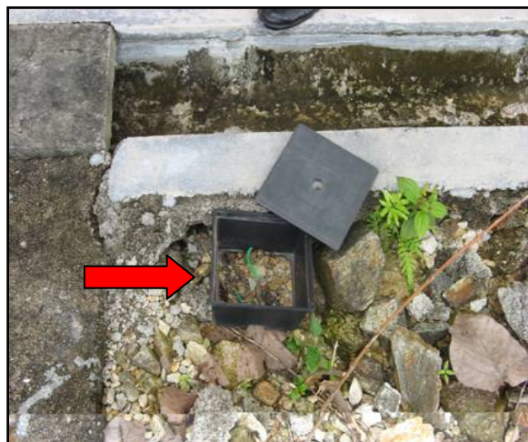
Foto 25 Ruang Pemeriksaan Pembumian Tidak Mengikut Spesifikasi
