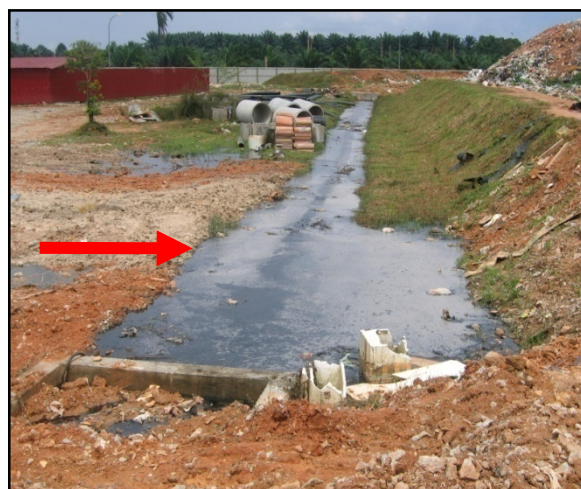
Foto 88 Parit Tanah Penuh Dengan Air Resapan Bercampur Dengan Air Hujan
