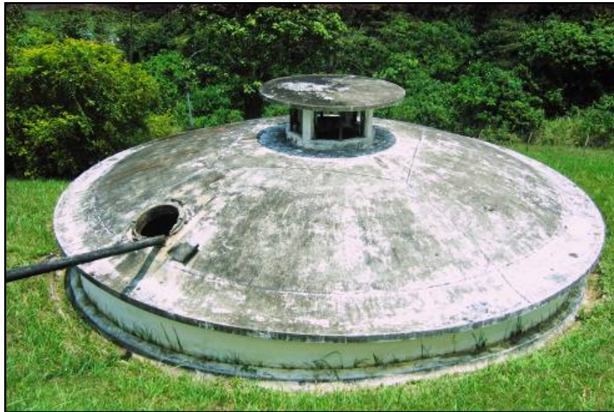
Foto 55 Tangki Imbangan Tidak Digunakan
