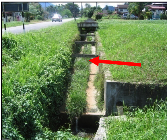
Foto 62 Longkang Besar Tidak Dibersihkan
