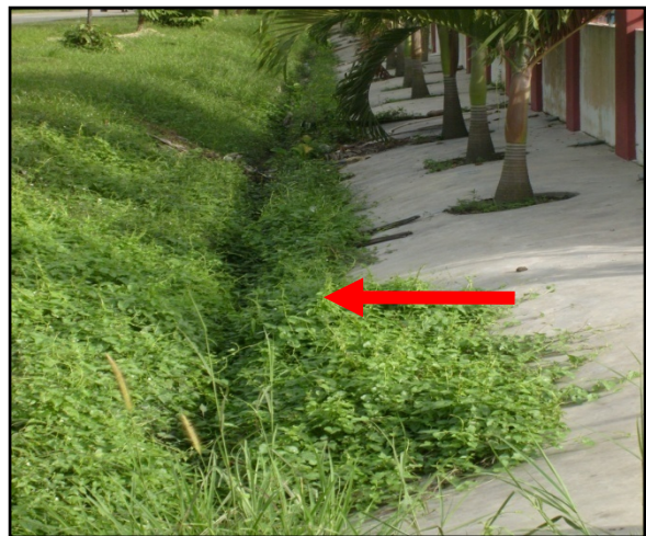
Foto 63 Longkang Tersumbat Dengan Rumput Yang Tidak Dipotong
