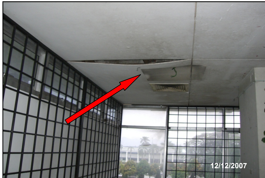
Foto 30 Siling Bilik Kebal Bocor
