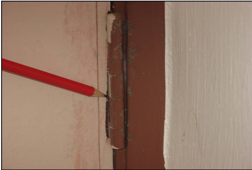
Foto 9 Engsel Pintu Tidak Dilengkapi Gegelang Nilon
