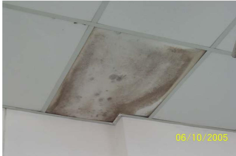
Foto 24 Siling Yang Diresapi Air
