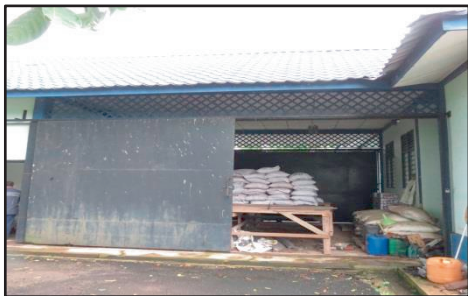
Stor Makanan Ternakan PSGT Bukit Kajang - Keadaan Stor yang Kurang Bersih dan Sistem Kawalan Kebakaran Tidak Diwujudkan (10.1.2019)
