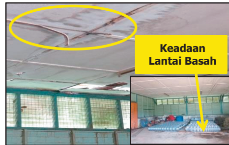
Stor Makanan Ternakan PSGT Ulu Lepar - Kebocoran pada Atap Siling (19.12.2018)
