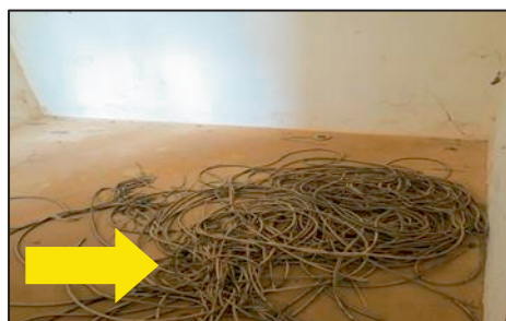
PAKR Sg. Pandan, Kuantan - Komponen Elektrik Dicuri (13.02.2019) (Sumber: Jabatan Audit Negara)
