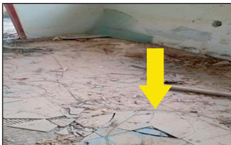
PAKR Sg. Pandan, Kuantan - Kerosakan Jubin Lantai (13.02.2019) (Sumber: Jabatan Audit Negara)
