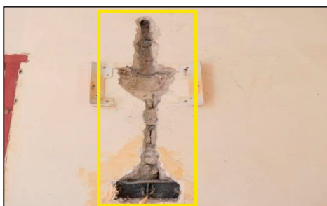
PAKR Sg. Pandan, Kuantan - Switch Socket Outlet dan Suis Hilang Dicuri (13.02.2019) (Sumber: Jabatan Audit Negara)
