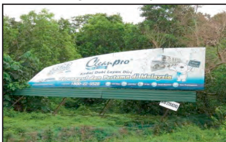
LPT KM235 Menghala ke Kuala Lumpur - Struktur Papan Iklan Dibina Hampir Roboh (23.11.2017)
