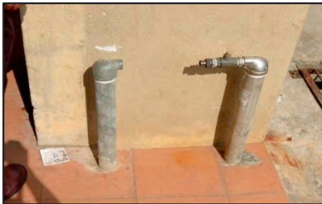
Jalan Tanah Putih Baru 15 - Meter Hilang (20.12.2017)
