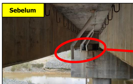
Jambatan Similajau - Pemasangan Paip Pembentungan uPVC Tidak Diikat Pada Struktur Konkrit (06.08.2019) (Sumber: Jabatan Audit Negara)
