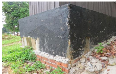
Pintu Gerbang Tasik Chini, Pekan - Keadaan Struktur Beam yang Tidak Kemas dan Telah Retak (17.04.2018)
