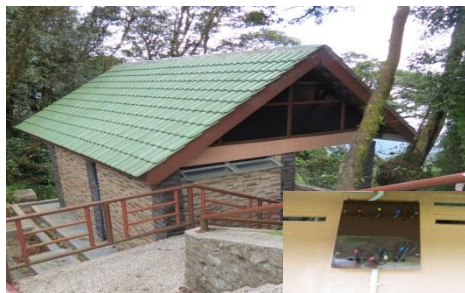
Bangunan Tandas Di Mossy Forest, Cameron Highlands - Keadaan Tandas yang Belum Dimanfaatkan Kerana Bekalan Elektrik Belum Dapat Dibekalkan (03.05.2018)
