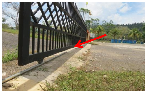
Kompleks Pelancongan Dan Jeti Sungai Chini, Pekan - Pintu Pagar Tidak Dapat Digunakan Kerana Besi Gelongsor pada Roda Telah Patah (17.04.2018)
