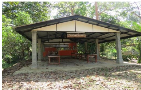
Gerai Jualan di Tasik Burung Mandi, Kemahang Benta, - Keadaan Bangunan Gerai yang Telah Dibina Tetapi Kurang Dimanfaatkan (13.03.2018)
