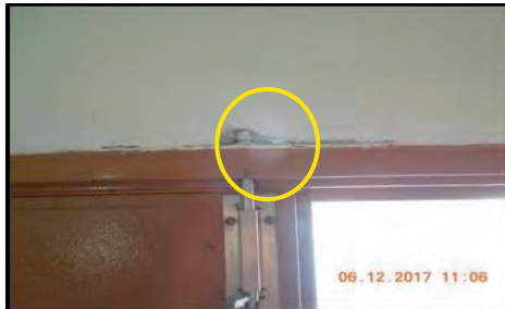
Bilik Kaunseling, Baitul Islah - Dinding Berlubang pada Bingkai Pintu (06.12.2017)
