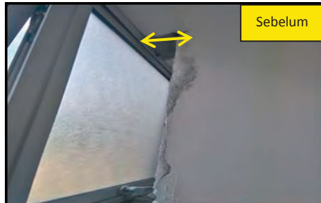
Blok Pentadbiran, Baitul Hikmah - Ruang Antara Dinding Pemisah Tandas Lelaki dan Wanita (06.12.2017)
