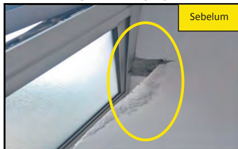
Blok Pentadbiran, Baitul Hikmah - Lepaan Dinding Tidak Kemas (06.12.2017)
