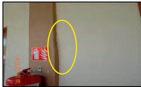
Ruang Luar Pejabat, Baitul Islah - Lepaan pada Tiang Tidak Lurus (06.12.2017)
