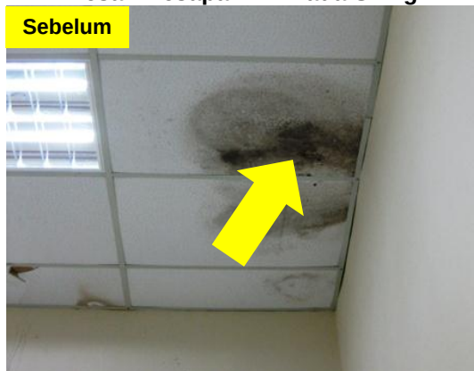
Gambar 1.9 Kesan Resapan Air Pada Siling
