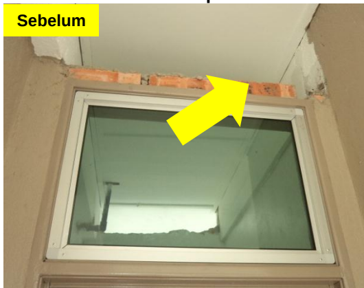
Gambar 1.15 Kemasan Simen Pada Dinding Tandas Tidak Sempurna
