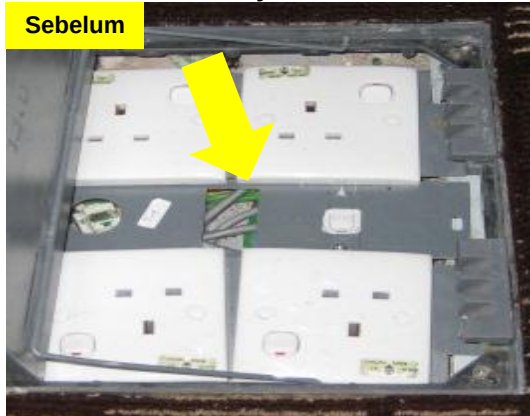
Gambar 1.25 Pemasangan Suis Tidak Kemas Kerana Wayar Kelihatan
