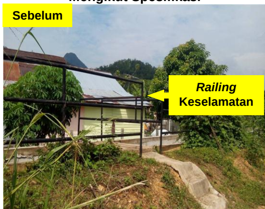
Gambar 4.7 Warna Railing Keselamatan Tidak Mengikut Spesifikasi
