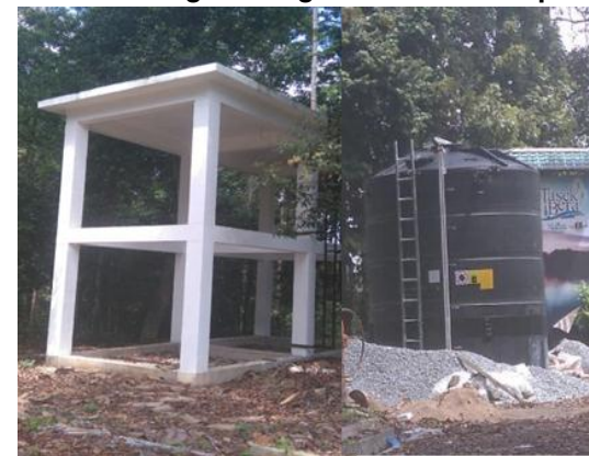
Gambar 3.6 Pemasangan Tangki Air Belum Siap
