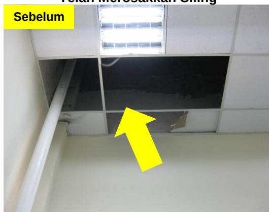
Gambar 1.11 Kesan Resapan Air Telah Merosakkan Siling
