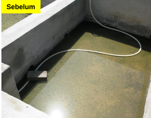
Gambar 1.13 Air Hujan Bertakung Di Atas Bumbung
