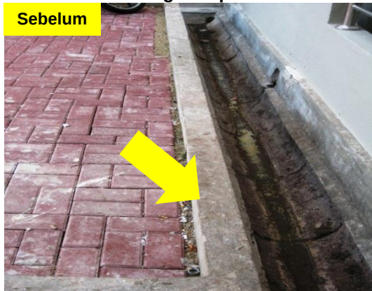
Gambar 1.19 Pemasangan Interlocking Kurang Sempurna
