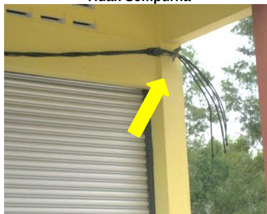
Gambar 3.15 Pemasangan Kabel Elektrik Tidak Sempurna
