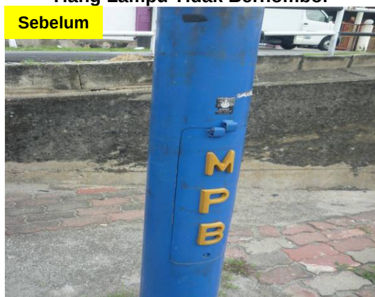
Gambar 4.9 Tiang Lampu Tidak Bernombor
