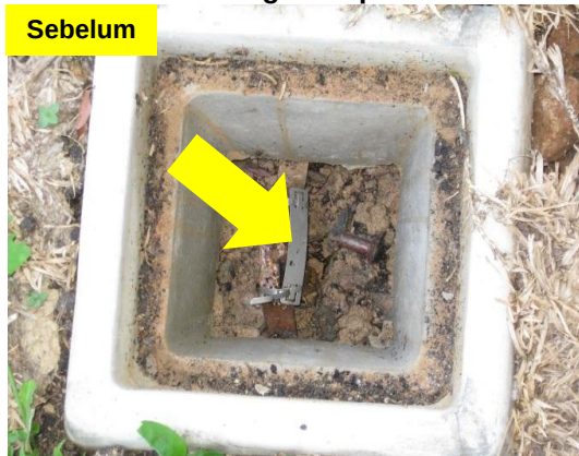
Gambar 1.31 Pemasangan Earth Electrode Tidak Dilabel Mengikut Spesifikasi
