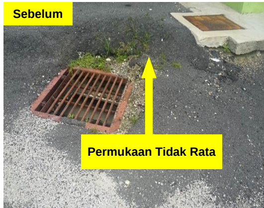
Gambar 4.15 Permukaan Dataran Kejut Tidak Rata
