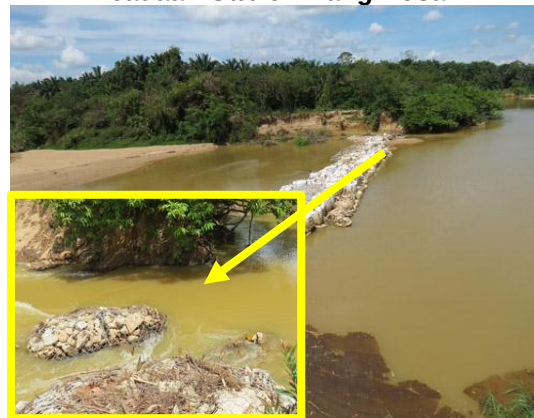
Gambar 2.3 Keadaan Gabion Yang Rosak
