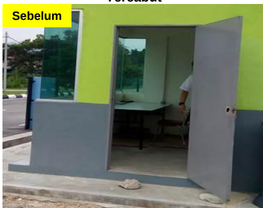
Gambar 4.11 Concrete Counter Top Tidak Dibuat, Lantai Tidak Berjubin Dan Tombol Pintu Tercabut
