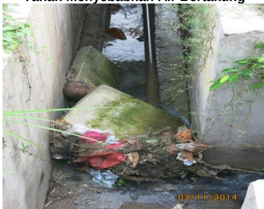
Gambar 2.4 Kerja Desilting Tidak Dilakukan Terhadap Bongkah Batu Dan Mendapan Tanah Menyebabkan Air Bertakung
