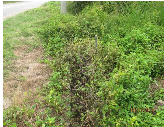
Gambar 2.9 Longkang Tidak Dibersihkan
