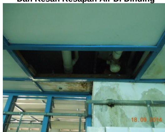
Gambar 4.6 Siling Tandas Asrama Yang Berlubang Dan Kesan Resapan Air Di Dinding
