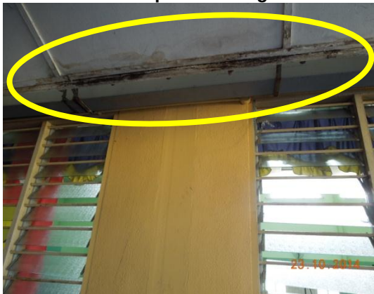
Gambar 4.7 Salur Air Hujan Tidak Mampu Menahan Limpahan Air Menyebabkan Resapan Di Siling
