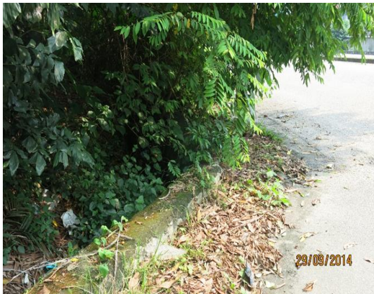
Gambar 2.2 Kerb Dan Scupper Drain Tidak Dibersihkan
