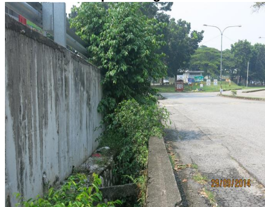
Gambar 2.3 Tumbuhan Liar Yang Besar Menunjukkan Longkang Tidak Dibersihkan Dalam Tempoh Yang Lama
