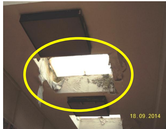
Gambar 4.8 Cat Di Siling Dewan Makan Yang Lusuh Dan Tanggal Akibat Resapan Air
