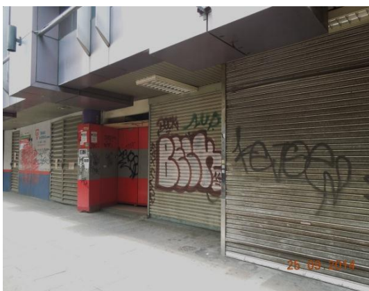
Gambar 4.24 Vandalisme Di Bangunan Yayasan, Bukit Bintang
