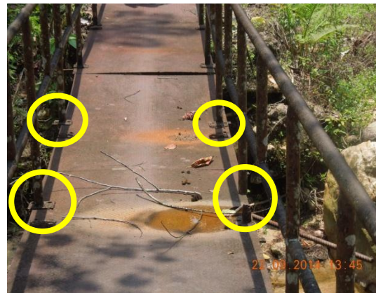
Gambar 4.20 Penyambung Jambatan Besi Tercabut
