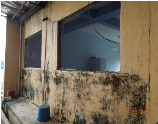
Gambar 4.26 Bangunan AYSKL Yang Dikosongkan Terbiar Dan Rosak
