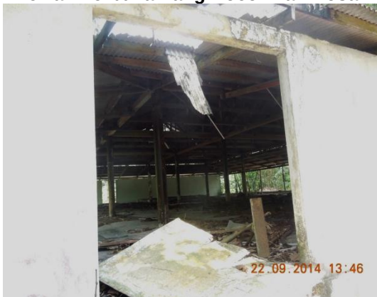
Gambar 4.21 Dewan Terbuka Yang Bocor Dan Rosak
