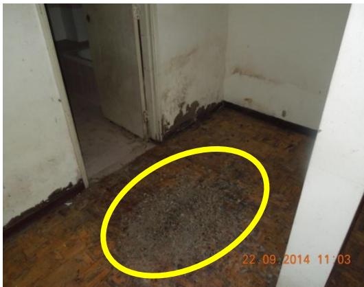
Gambar 4.19 Lantai Rosak Akibat Kebocoran Salah Sebuah Unit Kondominium
