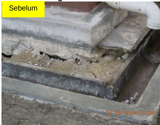
Gambar 4.7 Struktur Slab Lantai Pecah Di Bangunan Pentadbiran
