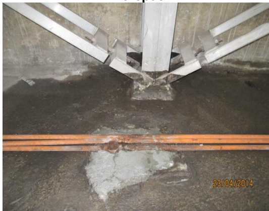
Gambar 1.7 Pendawaian Dibuat Di Atas Permukaan Lantai Di Bahagian Kubah Terdedah Kepada Takungan Air Hujan Dan Perumah Wayar Mereput
