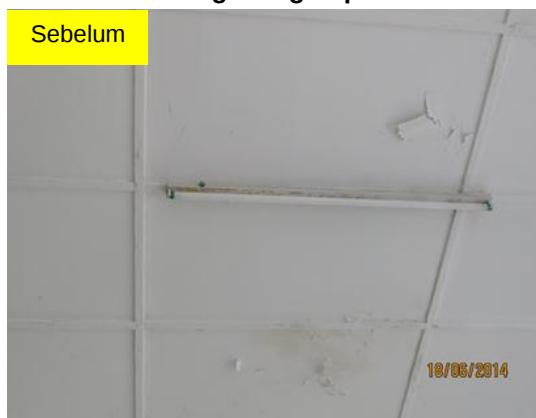
Gambar 1.25 Cat Yang Disapu Pada Permukaan Siling Mengelupas
