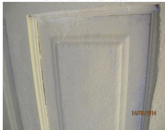
Gambar 1.16 Semua Panel Pintu Dan Frame Kayu Tidak Dicat Dengan Baik Menyebabkan Permukaan Pintu Kasar
