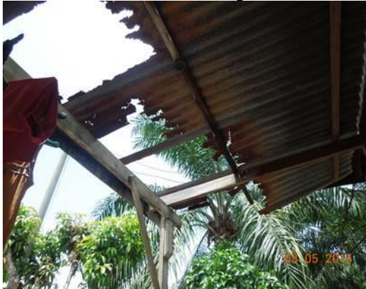
Gambar 2.1 Keadaan Bumbung Rumah Penerima SBA Yang Rosak
