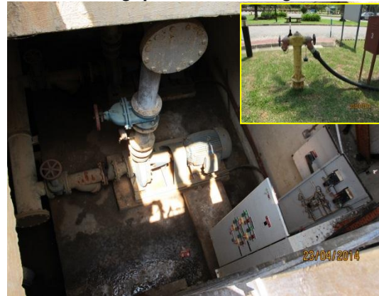
Gambar 1.12 Pam Bawah Tanah Rosak Dan Pili Bomba Digunakan Untuk Penyelesaian Sementara Mengepam Air Ke Tangki
