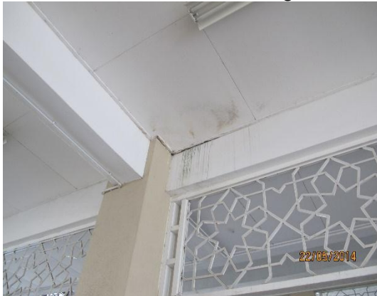
Gambar 1.1 Kebocoran Bumbung Menyebabkan Kerosakan Pada Siling
