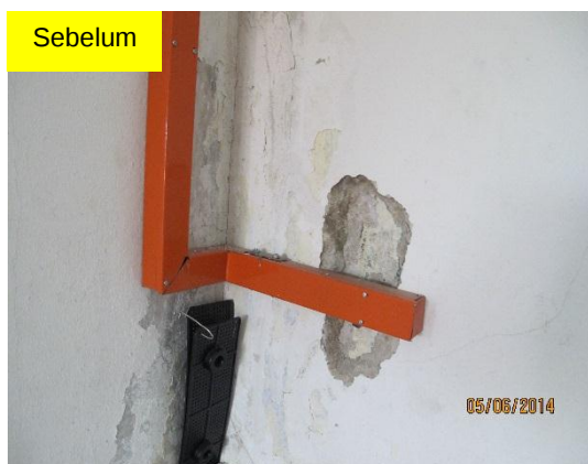
Gambar 1.23 Dinding Yang Ditebuk Untuk Pendawaian Semula Penyaman Udara Tidak Disimen Semula
