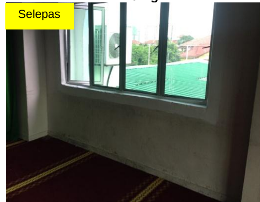
Gambar 1.22 Lepaan Simen Pada Bingkai Tingkap Yang Diganti Telah Dicat Mengikut Warna Asal Dinding
