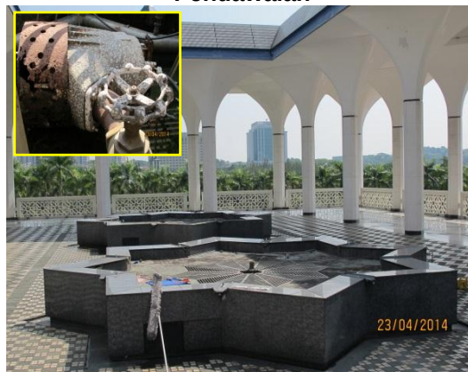
Gambar 1.10 Pancuran Bintang Tidak Berfungsi Kerana Kerosakan Motor Pump Dan Masalah Pendawaian
