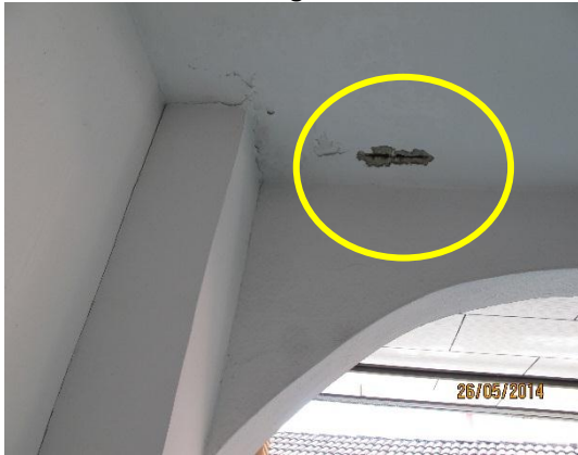
Gambar 1.5 Kegagalan Waterproofing Disebabkan Keretakan Bahagian Bawah Bumbung Konkrit
