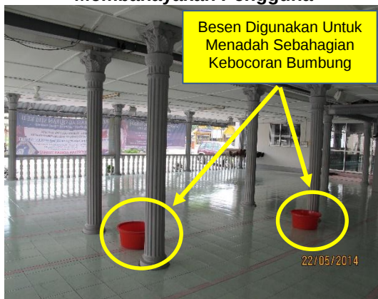
Gambar 1.3 Kebocoran Bumbung Menyebabkan Lantai Licin Dan Membahayakan Pengguna
