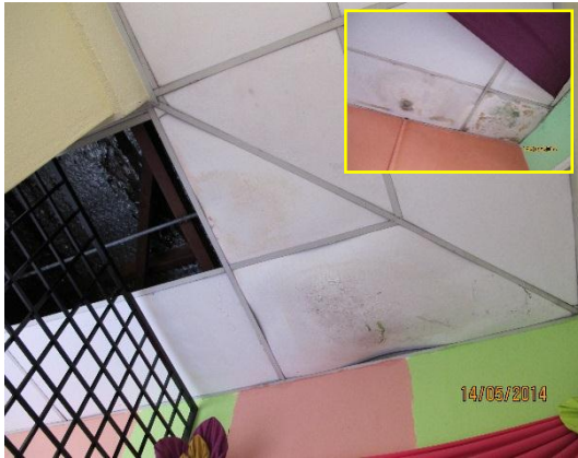
Gambar 1.19 Terdapat Kerosakan Bumbung Tidak Dibaiki Semasa Kerja Baik Pulih Dilaksanakan
