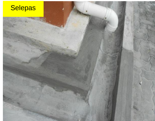
Gambar 4.8 Struktur Slab Lantai Pecah Di Bangunan PentadbiranTelah Dibaik Pulih
