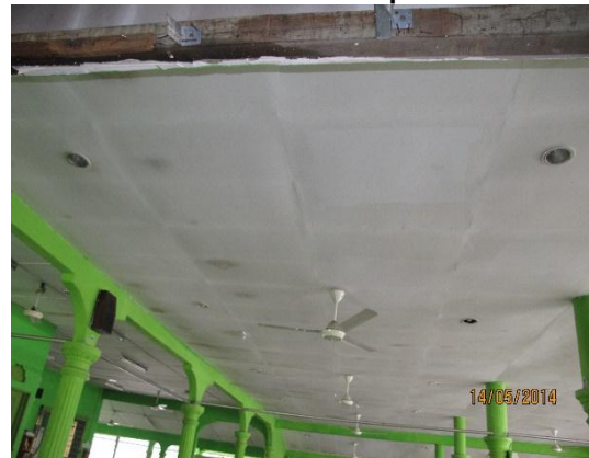
Gambar 1.4 Kebocoran Bumbung Di Banyak Tempat Menyebabkan Struktur Siling Beralun Dan Reput
