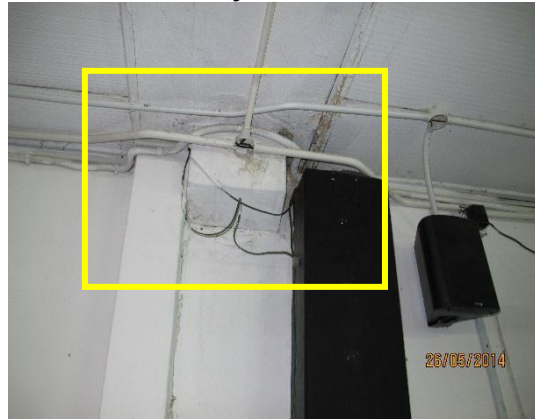
Gambar 1.6 Kebocoran Bumbung Menyebabkan Air Menitis Berhampiran Pendawaian Elektrik Dan Boleh Menyebabkan Litar Pintas
