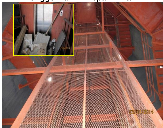
Gambar 1.9 Lif Pelancong Tidak Berfungsi Dan Terbiar Serta Sampah Sarap Binaan Dilonggokkan Di Depan Pintu Lif
