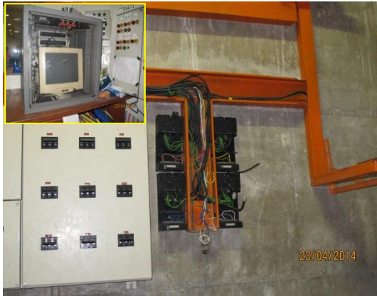
Gambar 1.11 Dimmer Untuk Lampu Chandelier Dan Unit Kawalan Lampu Berkomputer Rosak
