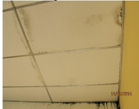
Gambar 1.20 Siling Yang Baru Diganti Pada Bulan Julai 2013 Rosak Semula Akibat Kebocoran Tidak Dibaiki Sebelum Penggantian Siling Dilaksanakan
