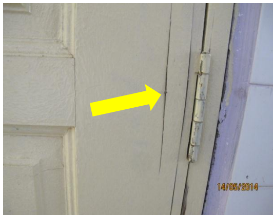
Gambar 1.15 Bahagian Pintu Yang Pecah Disebabkan Kerja Tukang
