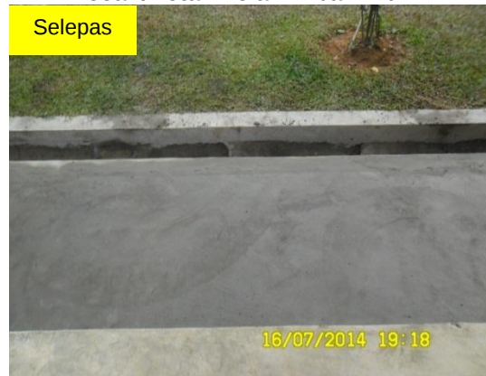
Gambar 4.10 Lantai Kaki Lima Bilik Pengajian Pecah/Retak Telah Dibaik Pulih
