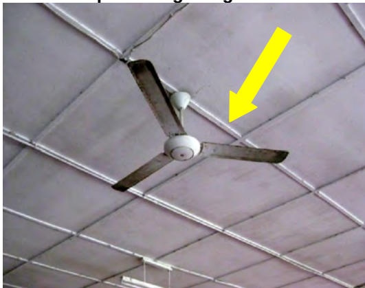
Gambar 5.17 Kipas Siling Yang Kotor
