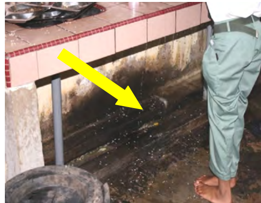
Gambar 5.18 Bawah Sinki Lama Tidak Dicuci
