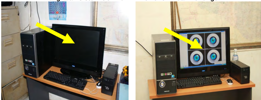
Gambar 8.2 Rangkaian Sistem CCTV di IPD Temerloh Tidak Berfungsi
