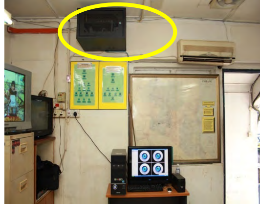
Gambar 8.6 Lokasi Server Di IPD Temerloh
