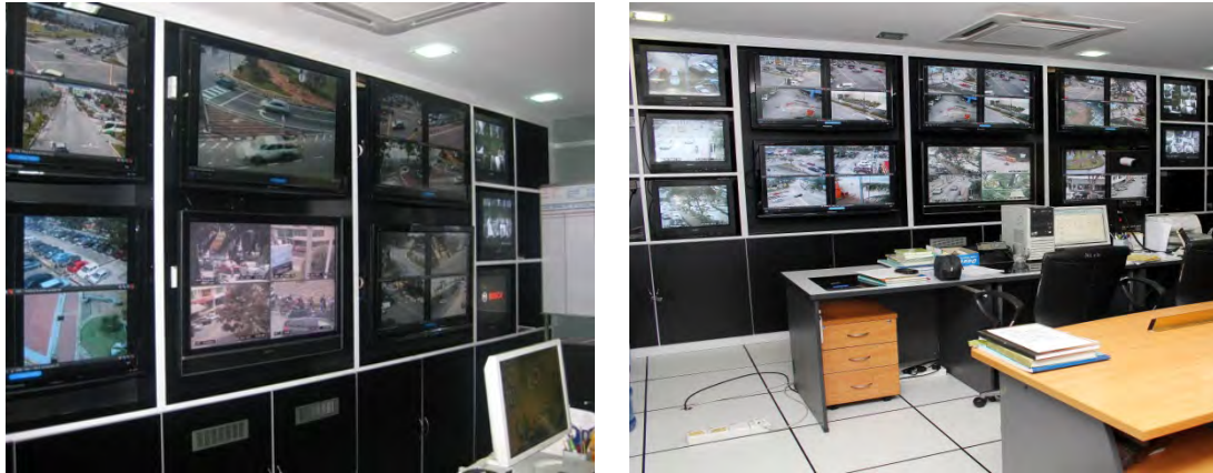
Gambar 8.4 Keadaan Bilik Kawalan CCTV Di IPD Kuantan
