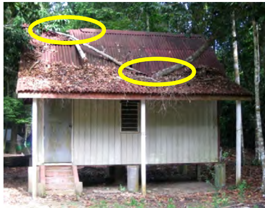
Gambar 6.18 Atap Kabin Yang Rosak
