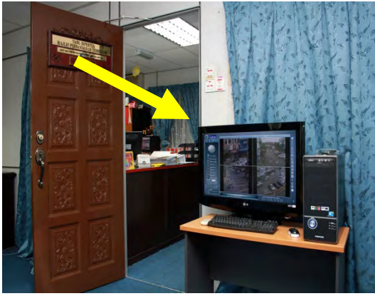
Gambar 8.11 Bilik Kawalan CCTV Di MPT Tidak Mempunyai Kawalan Akses
