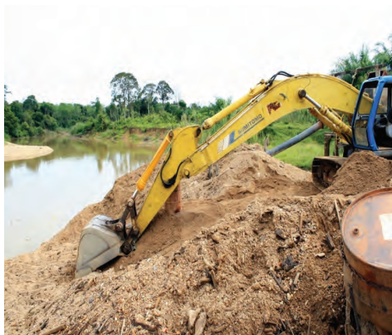
Foto 6.10 Jentera Berat Digunakan Di Tebing Sungai Menjejas Kestabilan Tebing Sungai
