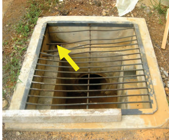
Foto 4.13 Jeriji Penutup Longkang Patah
