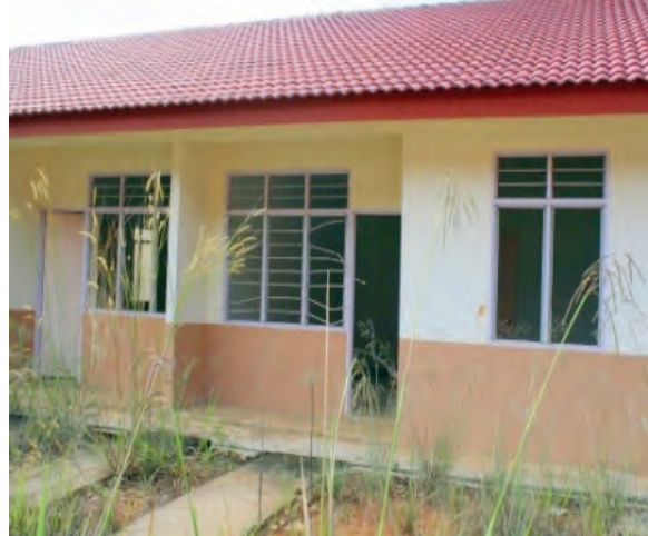
Foto 2.6 Jeriji Keselamatan Pada Tingkap Yang Telah Dicuri Di PPRM Kg. Sri Jaya, Maran
