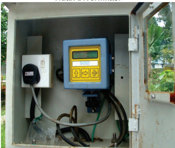
Foto 8.3 Meter Pengeluaran Yang Tidak Diverifikasi
