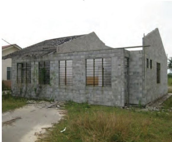
Foto 2.8 Rumah Yang Belum Siap Di PPRM Kuala Pahang Fasa II, Pekan
