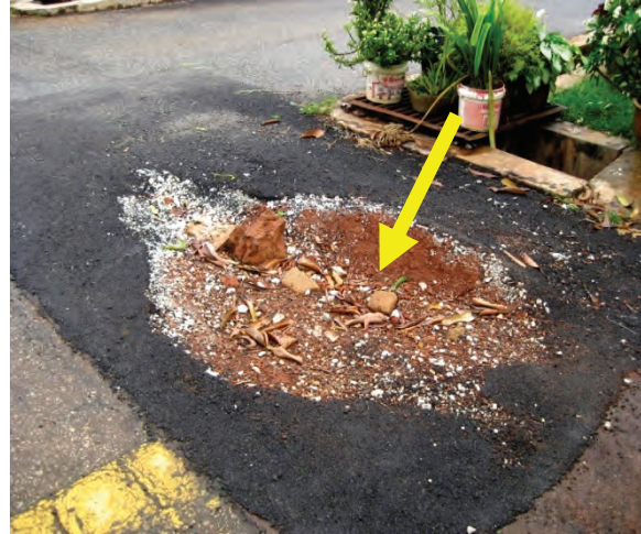
Foto 8.7 Pembaikan Yang Tidak Sempurna
