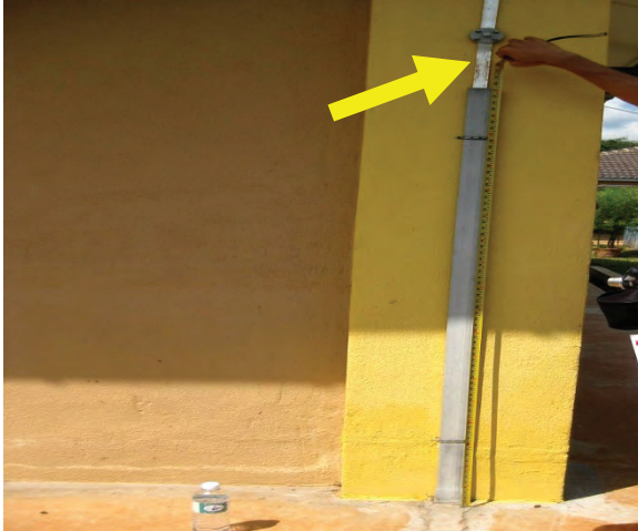
Foto 4.8 Pita Pembumian Kilat Yang Tidak Ditutup Boleh Dicapai Dengan Tangan
