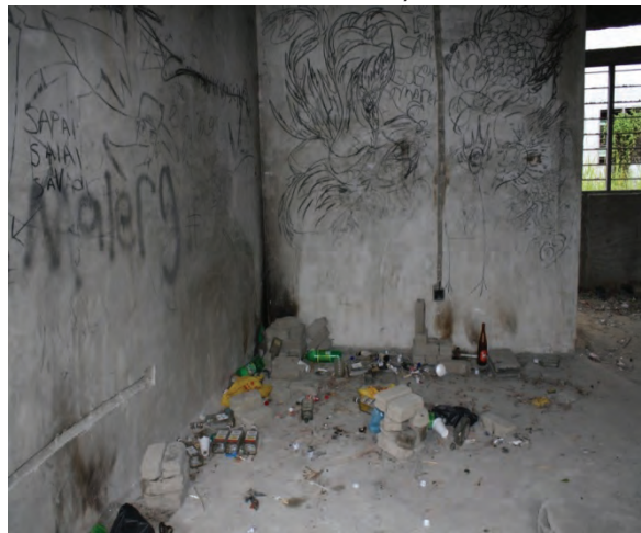
Foto 2.4 Aktiviti Vandalisme Dalam Bangunan Di PPRM Bandar Baru Fasa II, Jerantut
