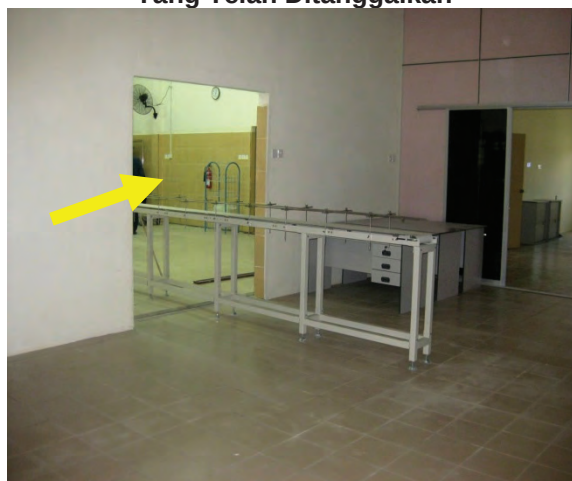
Foto 4.15 Lokasi Pintu Gelongsor Yang Telah Ditanggalkan
