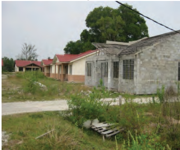
Foto 2.7 Keadaan Projek Yang Terbengkalai Di PPRM Kuala Pahang Fasa II, Pekan
