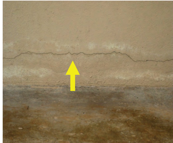
Foto 4.7 Keretakan Pada Dinding Bangunan Di Blok Bilik Kuliah
