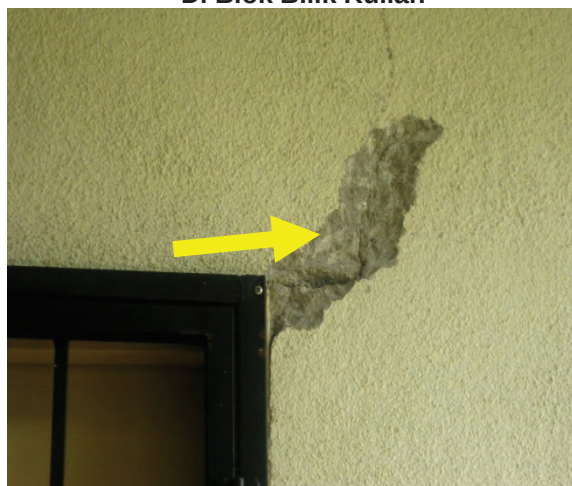
Foto 4.5 Keretakan Pada Dinding Bangunan Di Blok Bilik Kuliah
