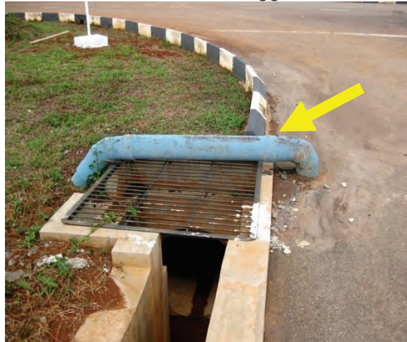
Foto 4.11 Kedudukan Paip Yang Membahayakan Keselamatan Pengguna
