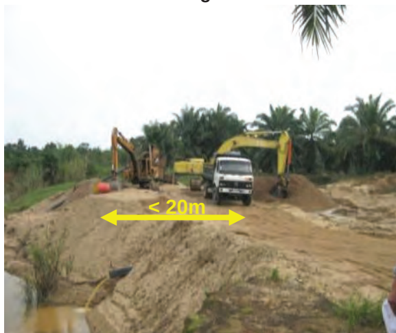
Foto 6.9 Stockpile Berada Kurang 20m Daripada Tebing Sungai. Kerja Mengisi Pasir Ke Dalam Lori Sedang Dilakukan
