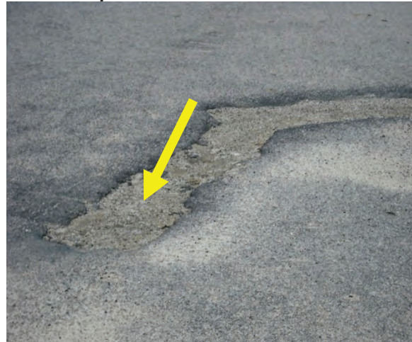
Foto 8.9 Kes Paip Pecah Tidak Diambil Tindakan
