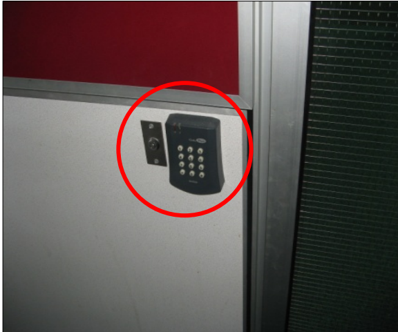
Foto 22 Alat Kawalan Khas Untuk Memasuki Bilik Server PTG
