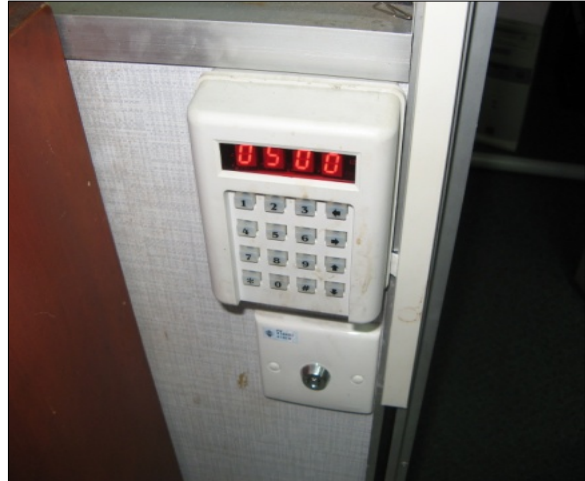
Foto 23 Alat Kawalan Khas Untuk Memasuki Bilik Server PDT Kuantan
