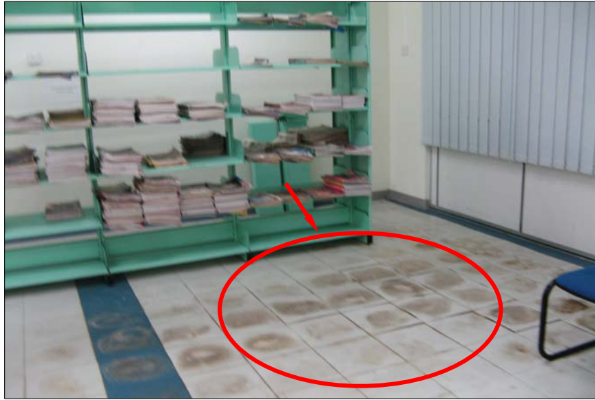
Foto 65 Lantai di Bilik Koleksi Negeri Rosak Akibat Dimasuki Air Di Perpustakaan Daerah Rompin
