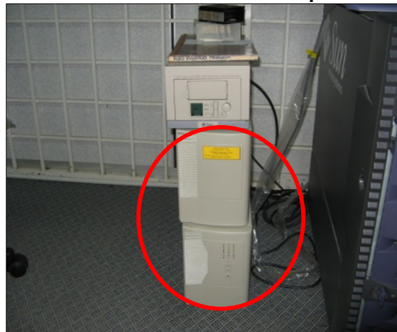
Foto 12 Penggunaan Uninterrupted Power Supply Di Bilik Server PDT Rompin
