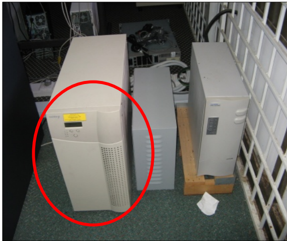
Foto 10 Penggunaan Uninterrupted Power Supply Di Bilik Server PTG
