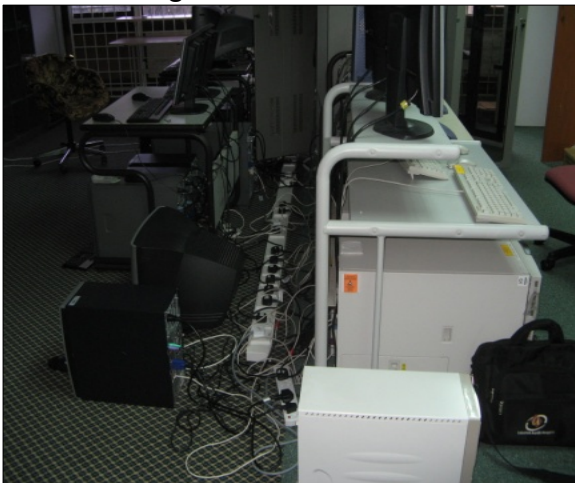
Foto 6 Pendawaian Elektrik Di Bilik Server Yang Tidak Teratur Di PTG
