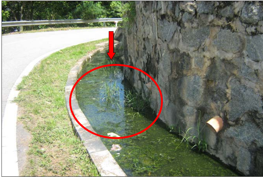
Foto 87 Longkang Tersumbat Dan Ditumbuhi Rumput Di Jalan Bukit Residen, Kuala Lipis
