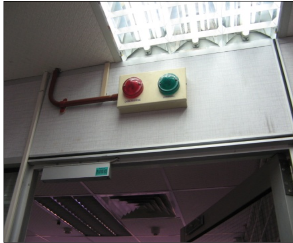
Foto 9 Alat Penggera Keselamatan Yang Dipasang Di Bilik Server PDT Kuantan
