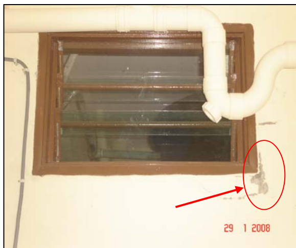
Foto 59 Keretakan Di Bahagian Dinding
