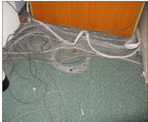
Foto 7 Pendawaian Elektrik Di Bilik Server Yang Tidak Teratur Di PDT Kuantan
