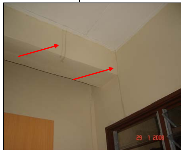
Foto 60 Kesan Air Keluar Dari Siling Kerana Atap Bocor
