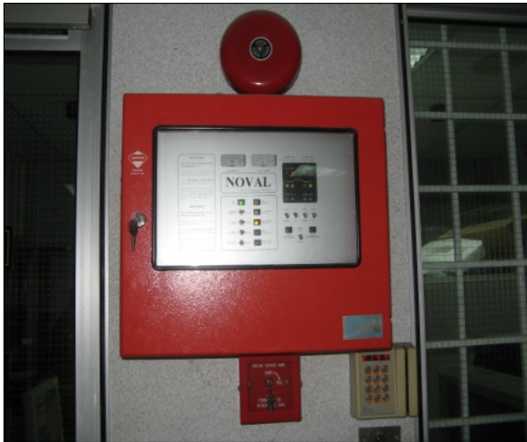
Foto 8 Alat Penggera Keselamatan Yang Dipasang Di Bilik Server PDT Rompin
