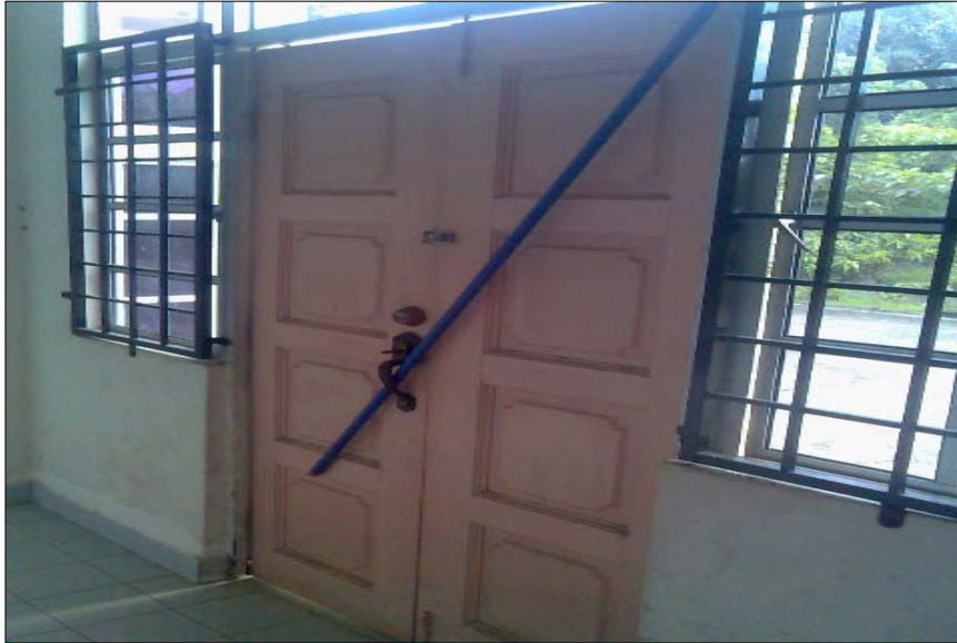
Foto 69 Pintu Belakang Perpustakaan Daerah Temerloh Tidak Dipasang Jeriji
