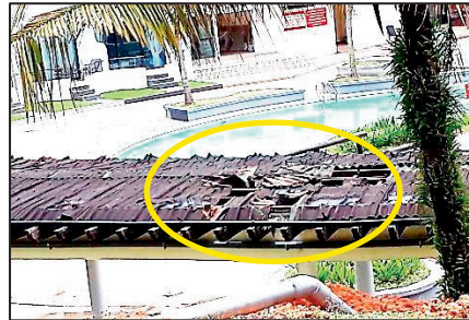
Laluan Pejalan Kaki ke Kolam Renang, ESSB - Keadaan Atap yang Rosak (31.10.2018) (Sumber: Jabatan Audit Negara)
