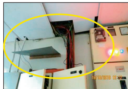
Laluan Utama Pekerja ke Lobi Hotel, ESSB - Keadaan Wayar Elektrik di Kotak Suis yang Terdedah (16.10.2018) (Sumber: Jabatan Audit Negara)
