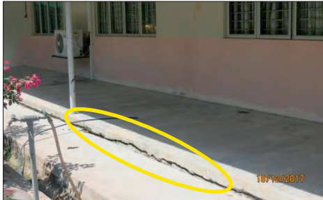
Kompleks Teknologi Pertanian, Ulu Sepri - Keretakan pada Apron di Bangunan Pentadbiran (18.12.2017)
