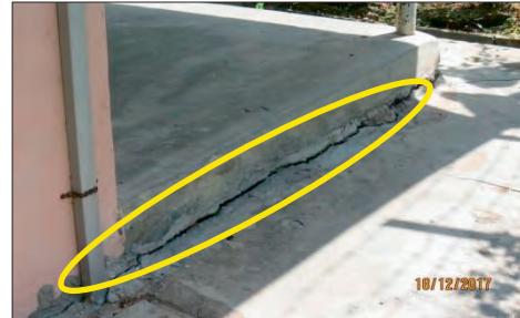
Kompleks Teknologi Pertanian, Ulu Sepri - Keretakan pada Apron di Bangunan Makmal (18.12.2017)
